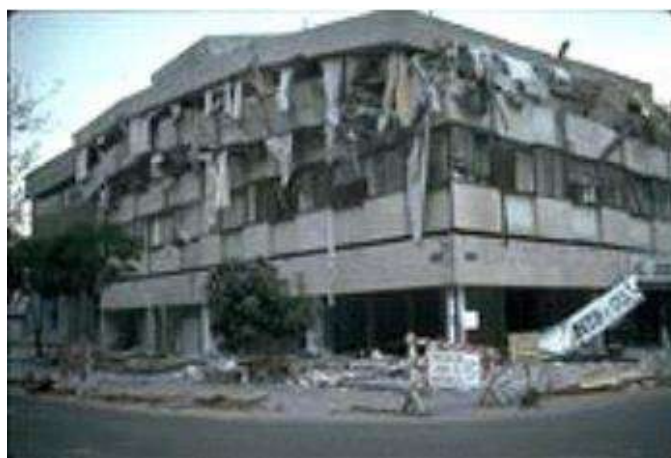
Figura II-10 Colapso de edificio con piso débil y de esquina durante el sismo del 19 de septiembre de 1985. Obtenido de (Colunga, 2004)
