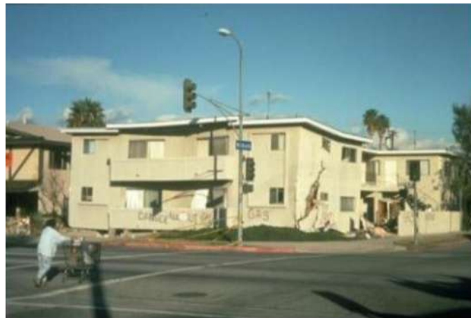
Figura II-14 Pequeño edificio de vivienda que falló debido al piso débil durante el sismo de Northridge. Obtenido de (Páez, 2017)
