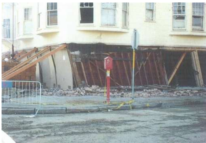
Figura II-12 Edificio con planta baja débil con severos daños debidos al sismo de Loma Prieta, Cal. en 1989. Obtenido de (Choshiro TAMURA, 1990)
