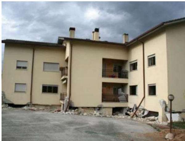
Figura II-19 Colapso de edificio debido a la presencia de primer piso blando debido al sismo de L'Aquila. Obtenido de (Ricci, 2011)
