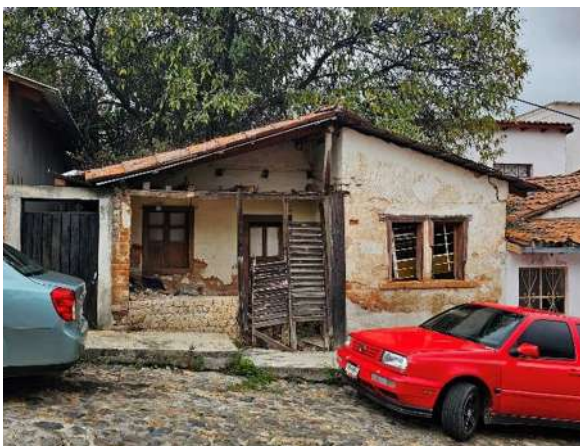
Fig. 161 Edificación histórica en grave deterioro (Tlalpujahua). Fotografía: Adrián Solís. julio 2023.
