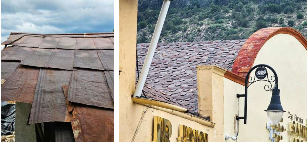
Fig. 91 Cubiertas metálicas producto del reciclaje de productos industriales; a la izquierda láminas y a la derecha tapones de tambos de cianuro. Fotografías: Adrián Solís. Julio 2023.
