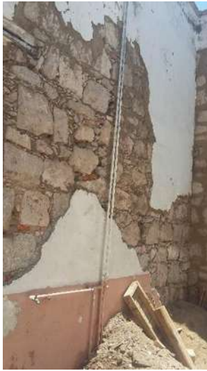
Figura 1. Morteros como protección de las estructuras. Foto: tomada por el autor.
