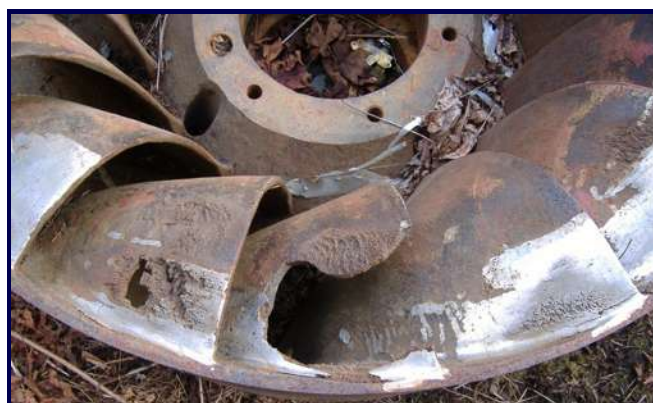
Figura 1.3: Daños por cavitación y reparaciones antiguas en un rodete de turbina Francis; obtenido de [WIKIPEDIA (25 de Abril de 2006)].
