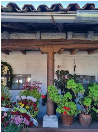
Ilustración 168 Apoyos verticales de madera en casa con características tradicionales Corredor Casa Loza. RILM
