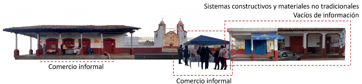
Ilustración 183 Alteraciones y deterioros Portal Morelos. RILM.
