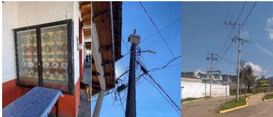
Ilustración 102 Instalación eléctrica existente en el área de estudio. RILM
