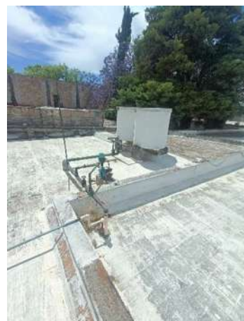
Ilustración 165 Instalaciones, fotografía propia.
