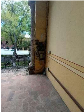
Ilustración 166 Instalaciones, fotografía propia.
