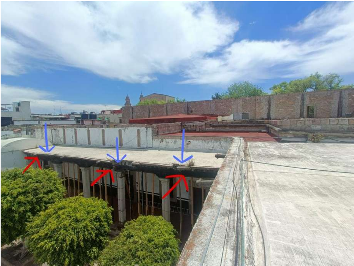
Ilustración 201 Empujes en el área de mayor deterioro, fotografía propia.
