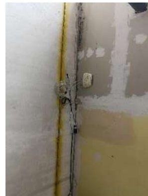
Ilustración 174 Cables visibles, cafetería, fotografía propia.
