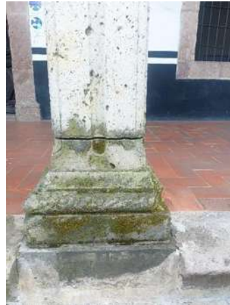
Ilustración 198 Alteraciones y deterioros, fotografía propia.
