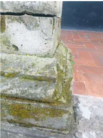
Ilustración 58 fotografía propia de pérdida de elementos, disgregación de la junta, presencia de microflora.
