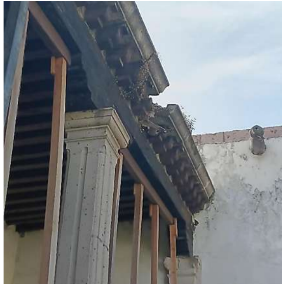
Ilustración 17 "Deterioros" 23 de octubre, 2023. Fotografía propia.
