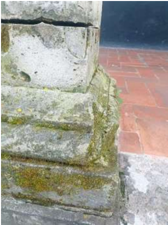
Ilustración 200 Alteraciones y deterioros, fotografía propia.
