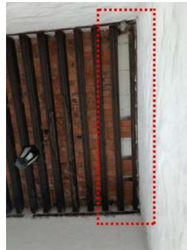
Ilustración 192 Tapa de ladrillo faltantes, fotografía propia.
