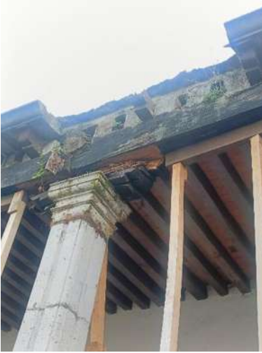
Ilustración 55 fotografía propia pérdida de elemento en cornisa, vigas sin puntas, pudrición de gualdras y zapatas, presencia de flora.
