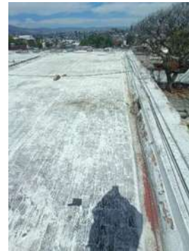
Ilustración 172 Instalaciones, fotografía propia.
