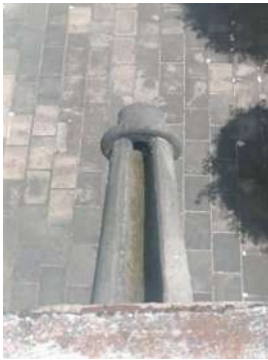
Ilustración 170 Instalaciones, fotografía propia.
