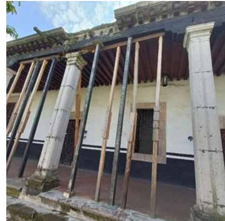
Ilustración 199 Alteraciones y deterioros, fotografía propia.
