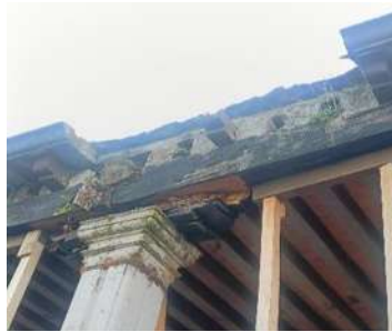
Ilustración 196 Alteraciones y deterioros, fotografía propia.
