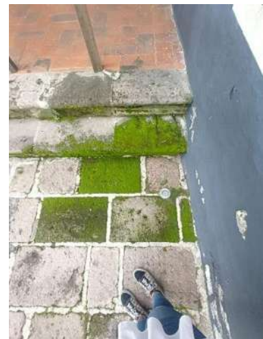
Ilustración 57 fotografía propia pérdida de elemento en piso, presencia de flora.
