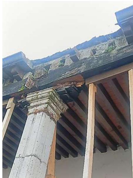
Ilustración 13 "Deterioros" 23 de octubre de 2023, fotografía propia.
