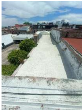
Ilustración 171 Instalaciones, fotografía propia.
