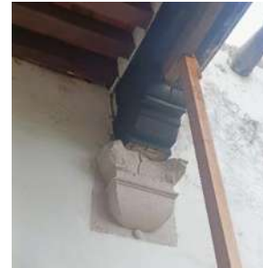
Ilustración 195 Alteraciones y deterioros, fotografía propia.
