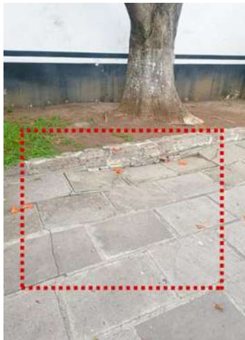
Ilustración 193 Piso fracturado, fotografía propia.
