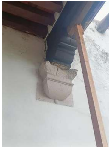
Ilustración 56 fotografía propia pérdida de elemento de cantería
