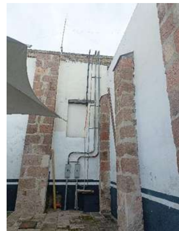
Ilustración 167 Instalaciones, fotografía propia.
