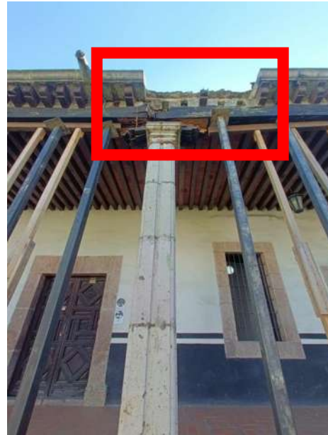
Ilustración 59 fotografía propia E2
