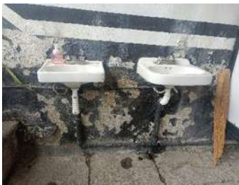
Ilustración 163 Instalaciones, fotografía propia.
