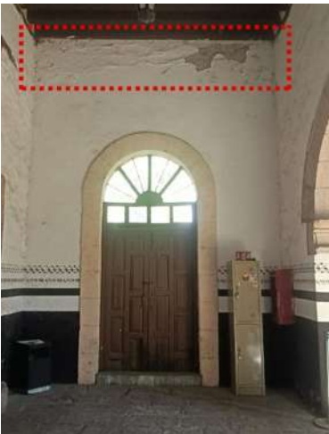
Ilustración 194 Pintura en mal estado, fotografía propia.
