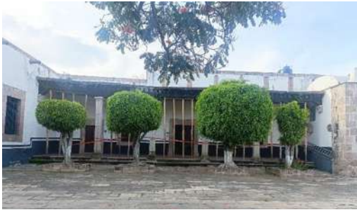
Ilustración 197 Alteraciones y deterioros, fotografía propia.
