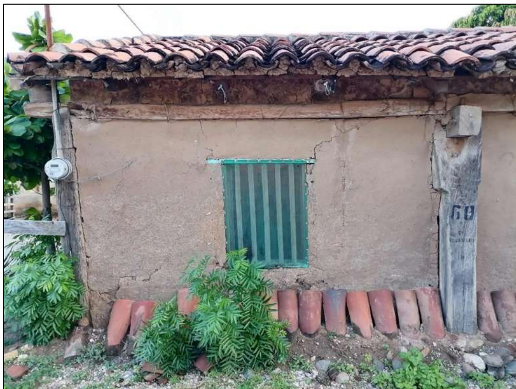
Figura 3-6. Daños en muros en vivienda de bajareque. Se aprecian tanto agrietamientos diagonales desde las esquinas de las ventanas, como separación del muro con pilares. Fuente: fotografía del autor, 2022.
