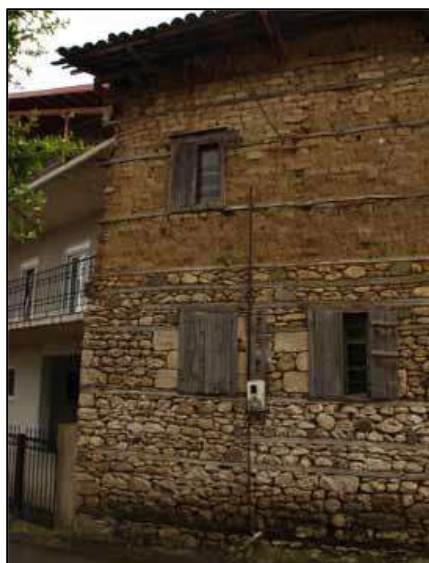
Figura 3-16. Ejemplo emblemático de reforzamientos horizontales de madera en construcciones de mampostería en Grecia. Fuente: Jorquera, 2014. 35
