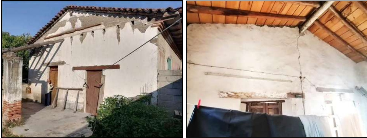
Figura 3-4. Vivienda afectada por el sismo de Pijijiapan, de volumetría regular, con cubiertas de dos aguas, localizada en Santiago Laollaga. Fuente: fotografías del autor, 2022.
