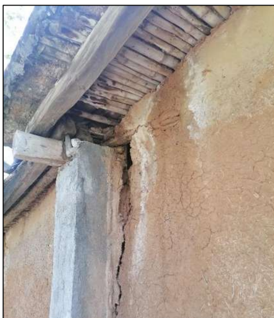
Figura 5-27. Daños por escurrimientos, vivienda 01LAB-V06. Fuente: Irving Sánchez, 2023.
