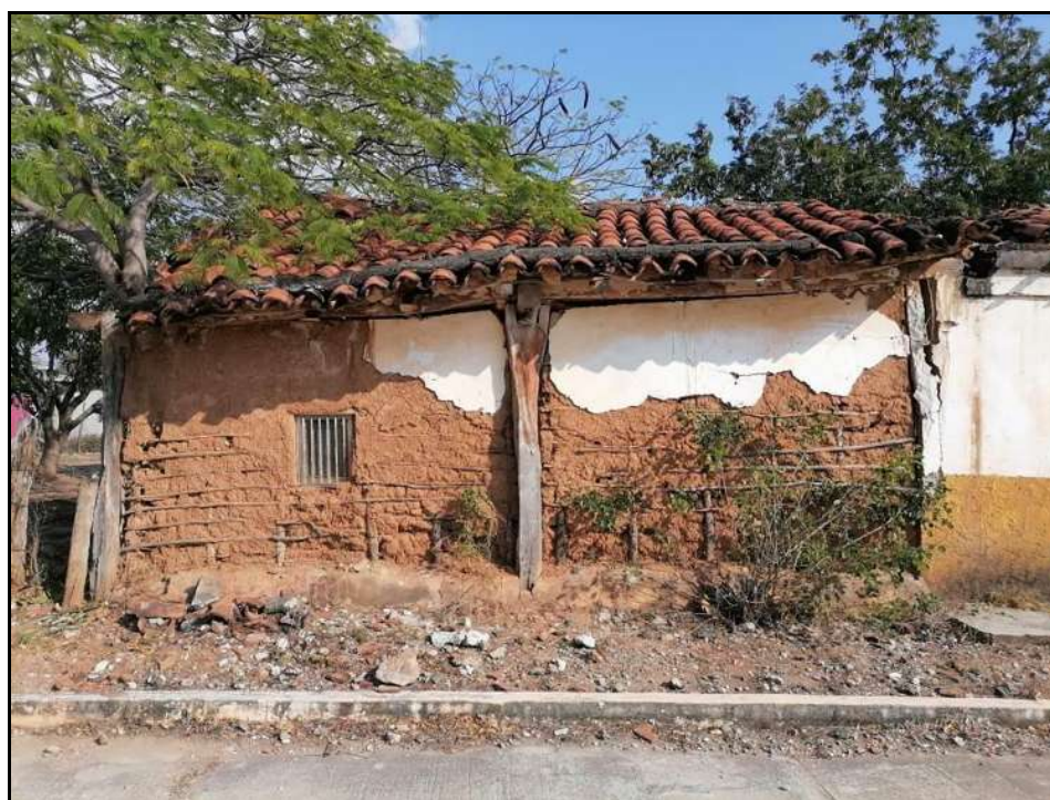
Figura 3-7. Vivienda en desuso severamente deformada. Fuente: fotografía del autor, 2022.
