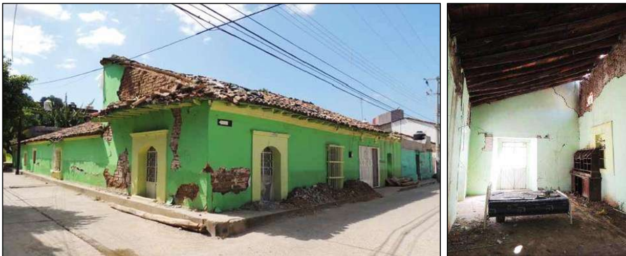
Figura 3-3. Vivienda afectada por el sismo de Pijijiapan, de volumetría irregular, con cubiertas a un agua, localizada en Tehuantepec. Fuente: FAHHO, 2020. 24
