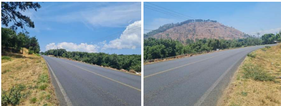
Figura 3-6. Carretera “Uruapan – El Copetiro” condición sin marca.
