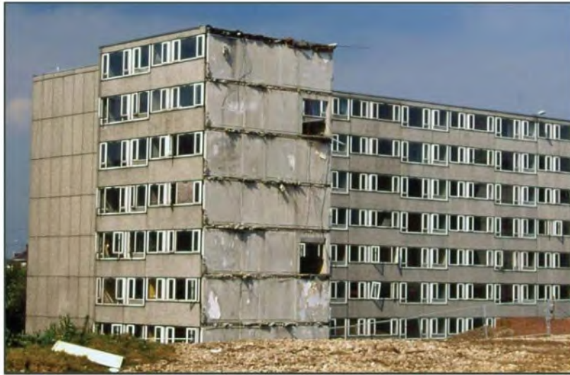
Figura 1.1 Muros prefabricados y losas alveolares utilizadas en edificios residenciales de la década de los 50's demolidos en 2002 (Tomada de Elliott y Hamid, 2017).
