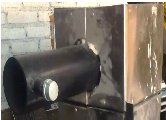
Figura 35.- Vista del cabezal con la salida del gas
