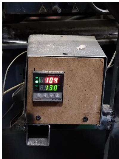
Figura 46.- Pirómetro programado a 130°C para comenzar a calentar las resistencias en el gasificador
