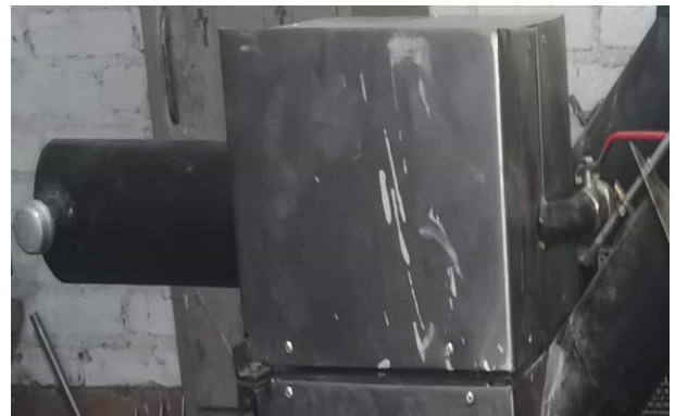
Figura 36.- Vista lateral izquierda donde se ve la llave de paso de aire para mejorar la combinación de syngas con oxígeno
