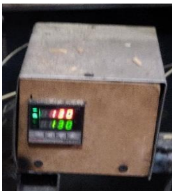
Figura 10.- Pirómetro encargado de controlar el encendido del gasificador y las temperaturas a través de dos termopares tipo K (Uso propio)
