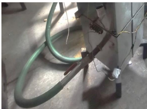
Figura 29.- Entrada de gasificante
