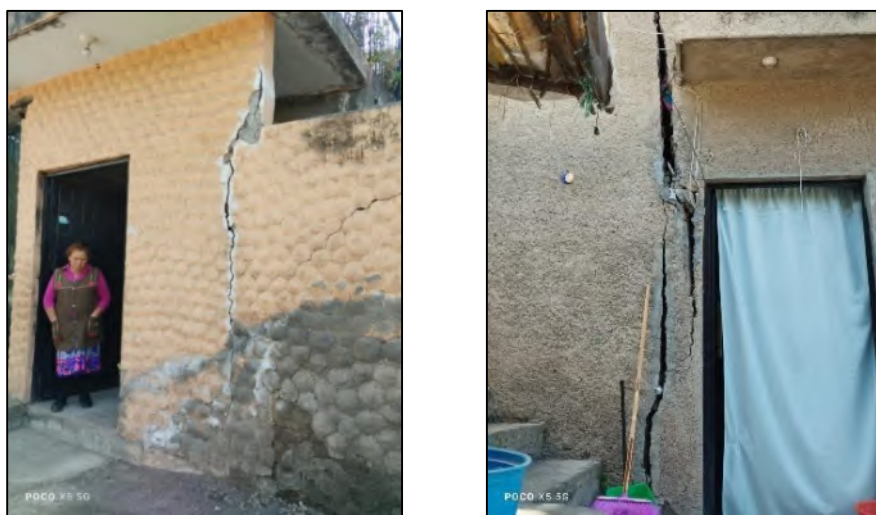
Figura 31. Viviendas afectadas estructuralmente en la localidad rural El Colegio. Coordenadas (-101.172873, 19.773348).
