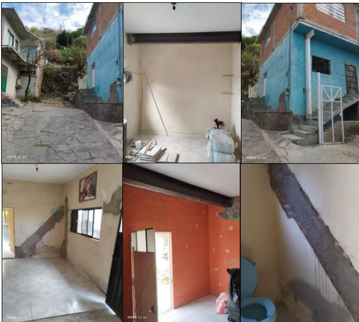
Figura 38. Vivienda identificada atípicamente con severos daños estructurales en castillos, muros de carga, paredes y pisos; ubicada en la localidad de Uruétaro, Mich. (-101.088072, 19.78943598), en las inmediaciones del escarpe principal de la falla. De acuerdo a su dueña, revisada por Protección Civil Municipal, emitiendo “dictamen” verbal de continuar habitándola por inexistencia de riesgo.
