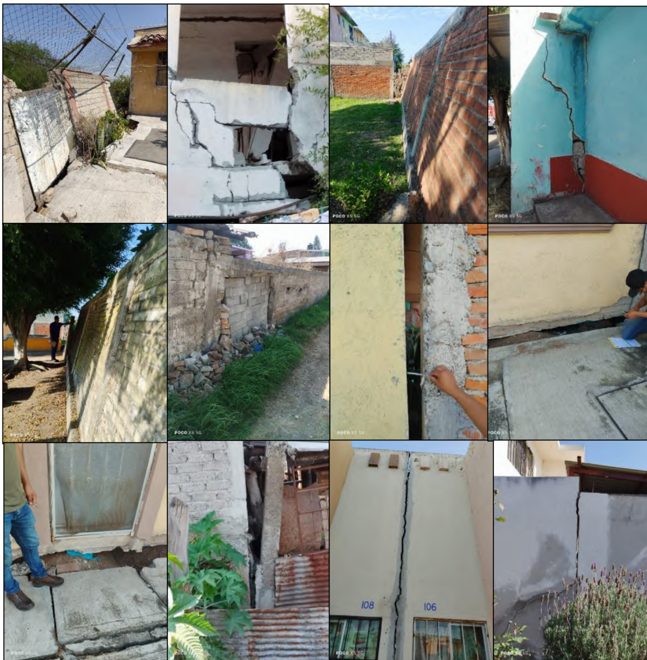
Figura 47. Algunos de los daños en viviendas y bardas perimetrales identificados en la zona de afectación.
