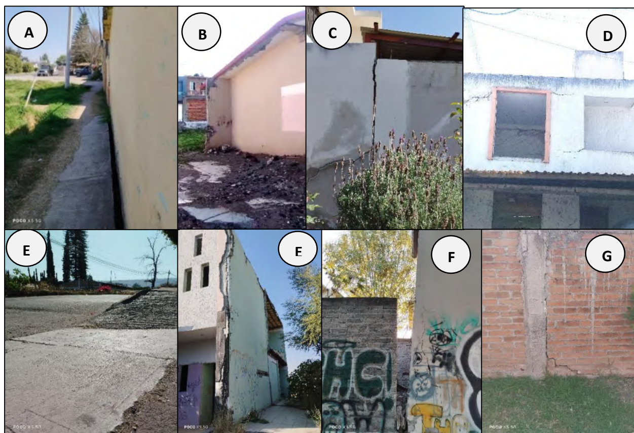
Figura 45. Algunos daños en la infraestructura fuera de los 50 m del buffer de afectación.
