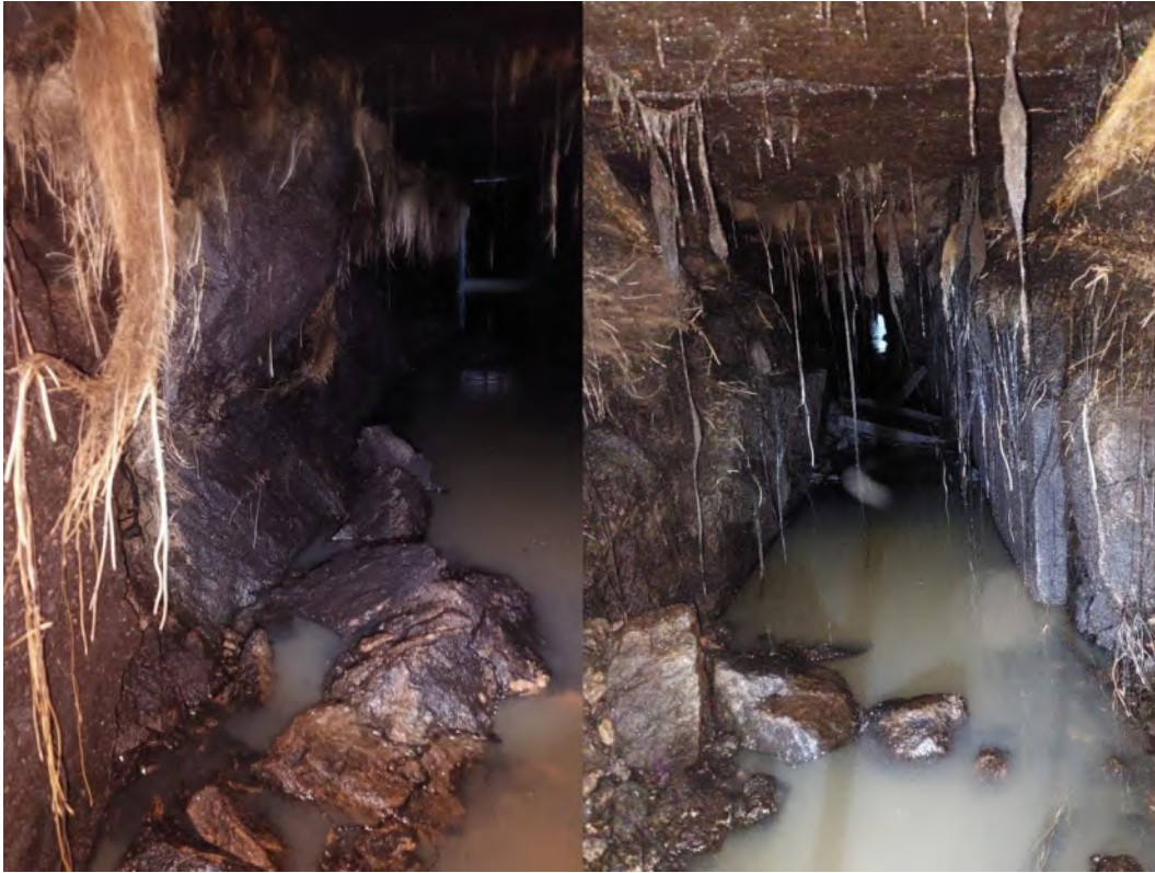
Figura 26.- Derrumbe localizado entre los pozos 18 y 19
