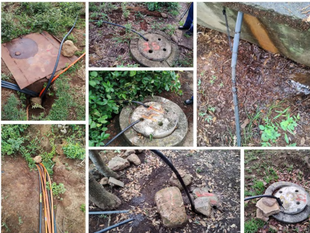
Figura 22.- Pozos y zonas del canal con extracciones clandestinas.
