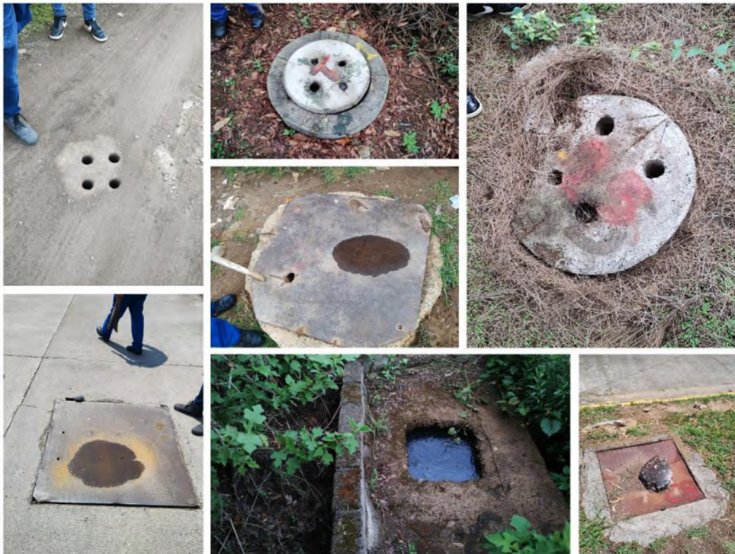
Figura 20.- Ejemplo de algunos pozos de visita común en el canal de conducción.
