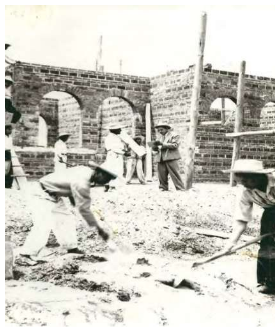
27. Fotógrafo desconocido, sin título, (hombres construyen la escuela primaria General, Casimiro Leco López), Cherán, Michoacán, México, Colección, Adalberto Muñoz Estrada.
