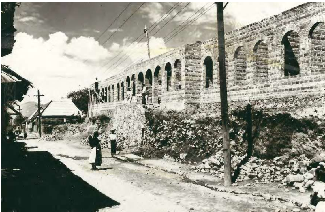
1. Fotógrafo desconocido, sin título, (hombres construyen la escuela primaria General, Casimiro Leco López), Cherán, Michoacán, México, Colección, Adalberto Muñoz Estrada.
