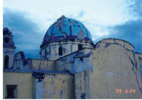
Foto 4 Mecanismo de falla en la cúpula y en muro de ábside del templo
