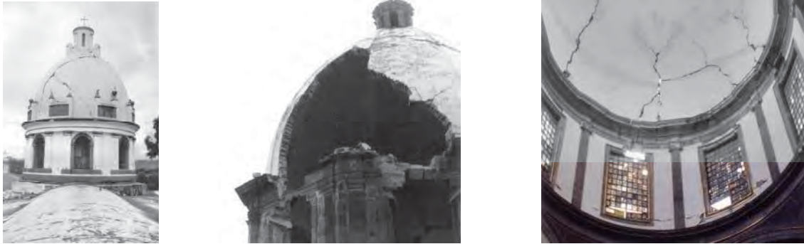
Foto 7 Falla por cortante en la cúpula
