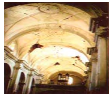
Foto 3 Mecanismo de falla de bóveda y arcos fajones
