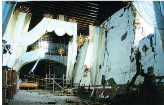
Foto. 1 Falla súbita por cortante en muro lateral norte del Templo de San Jerónimo Purenchecuaru Mpio de Quiroga, Mich.
