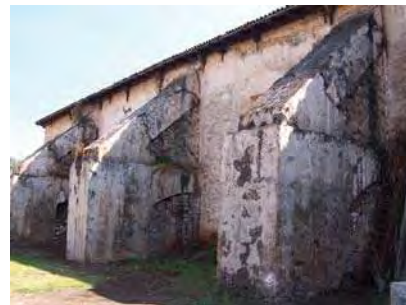
Foto 5 Falla por cortante en el contrafuerte botarel
