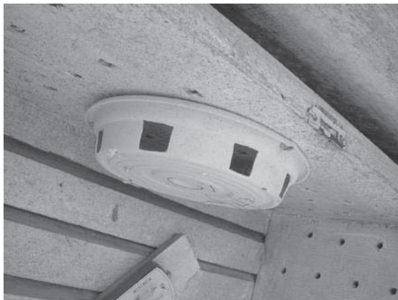
Figura 7. Protección del instrumental. Protección simbólica de los datalogger “huésped” en las pantallas de Stevenson de la CNA, para evitar la curiosidad de otros usuarios de la estación.
