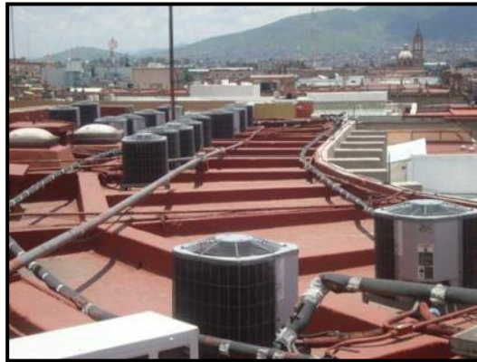
Figura 47. Azotea del hotel Alameda sectorizada por trabes que sobresalen de la losa. (E. Paredes, 2009).
