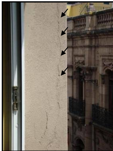
Figura 104. Cara sur de columnas del segundo piso del hotel Alameda fachada este. (E. Paredes, 2010).
