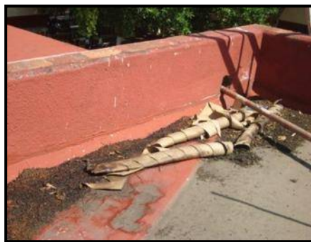
Figura 74. Losa de azotea de la escuela Independencia donde se observa un notable desaseo. (E. Paredes, 2010).
