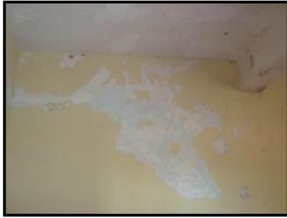
Figura 69. Humedad al interior del edificio que ha comenzado a dañar la pintura de las paredes de la P.A. (E. Paredes, 2010).
