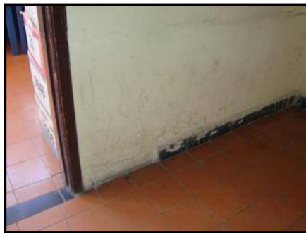
Figura 73. Zoclos faltantes en algunos de los salones del centro escolar. (E. Paredes, 2010).
