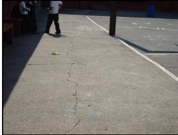
Figura 78. Patio sur del centro escolar Independencia donde se observan agrietamientos. (E. Paredes, 2010).
