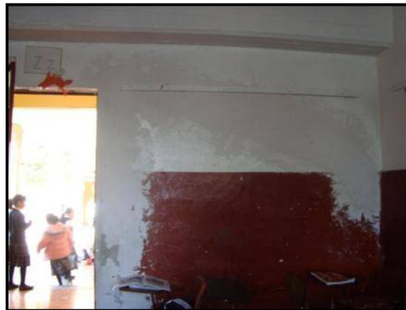
Figura 77. Resane de grieta en muro del salón ubicado en el ala sur de la P.B. (E. Paredes, 2010).
