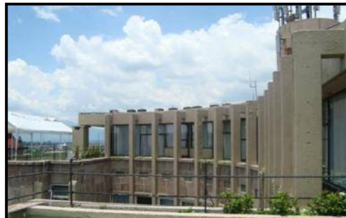
Figura 46. Quinto piso del hotel Alameda donde se observa la continuación de las pilastras originales del edificio. (E. Paredes, 2009).
