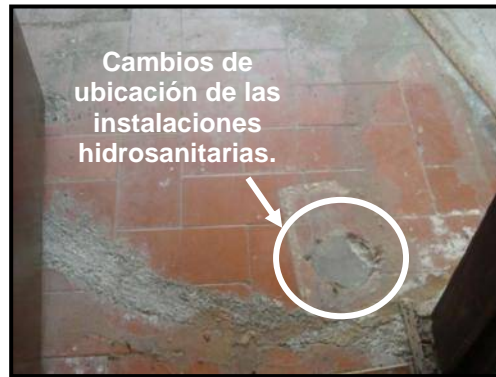
Figura 43. Cambios realizados al interior del hotel en las instalaciones hidrosanitarias. (E. Paredes, 2009).
