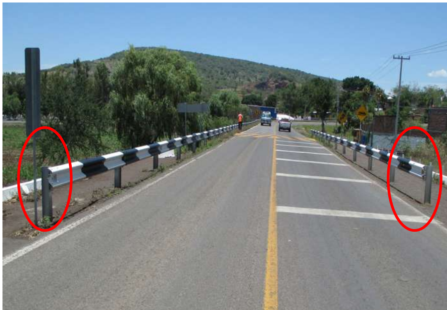
Foto 6.4. Barreras de protección sin terminación.
