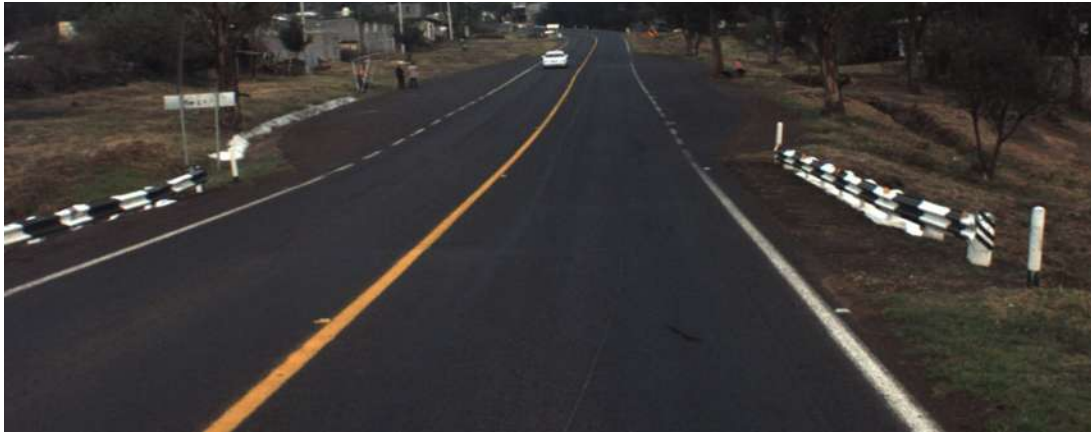
Foto 6.1. Barreras de protección no cumplen con altura de 55cm
