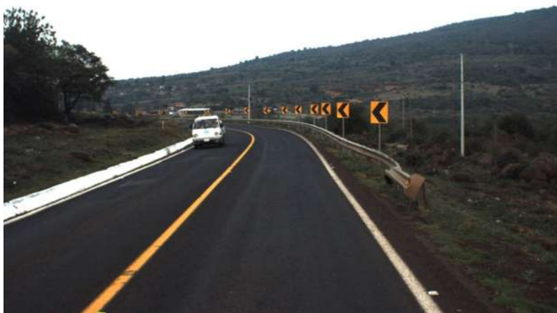
Foto 5.9. Barrera de protección en mal estado.
