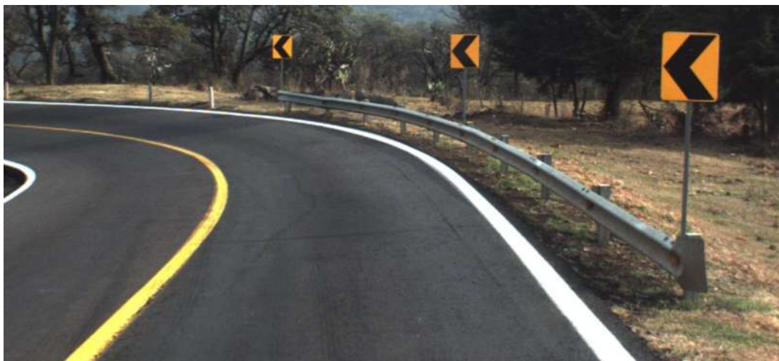
Foto 6.2. Barrera de protección en orilla de la corona no cumple con altura.
