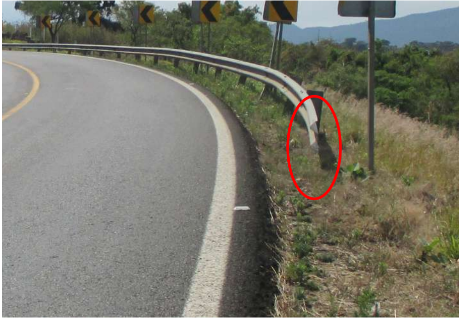
Foto 6.3 Barrera de protección sin terminación.
