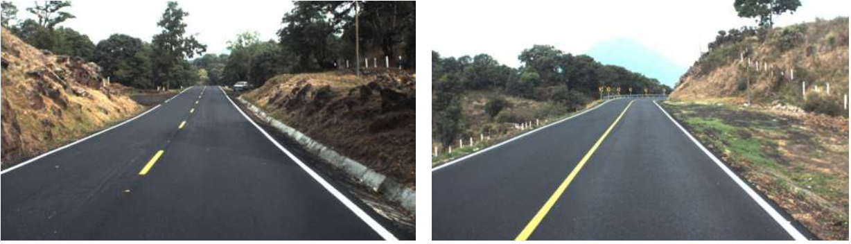
Fotos 5.14 y 5.15, rayas horizontales en buen estado.
