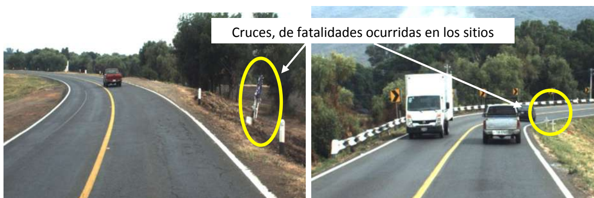
Fotos 5.10 y 5.11 Sitios donde hace falta instalar barrera de protección en la orilla de la corona lado derecho, en ambos casos.
