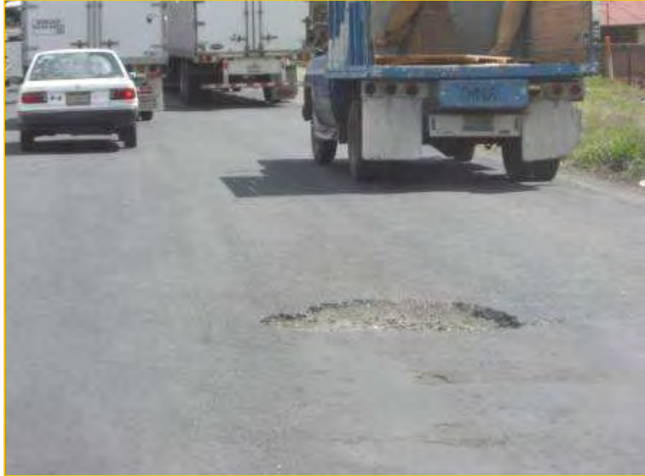
Fig. 6.5: Falla estructural por fatiga presentada en el Tramo.
