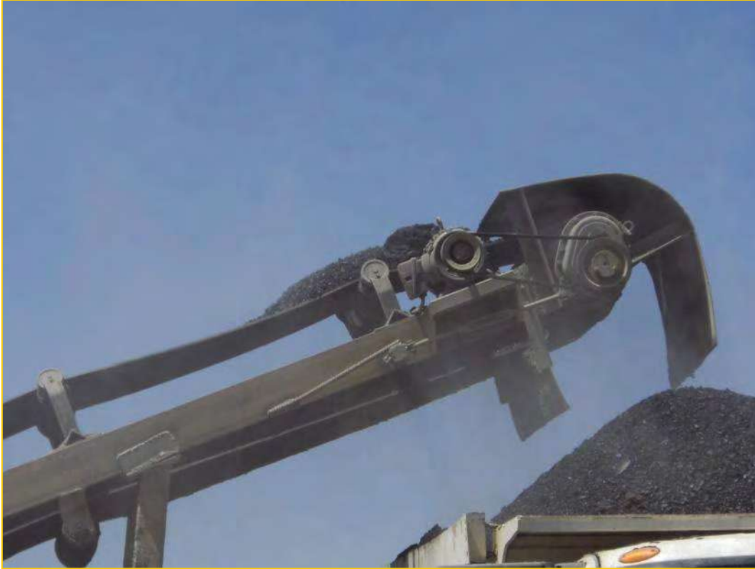
Fig. 6.21: Conglomerado de mezcla asfáltica fría detectado el día 27 de marzo de 2010 que se produce en el tambor mezclador por la falta de limpieza.
