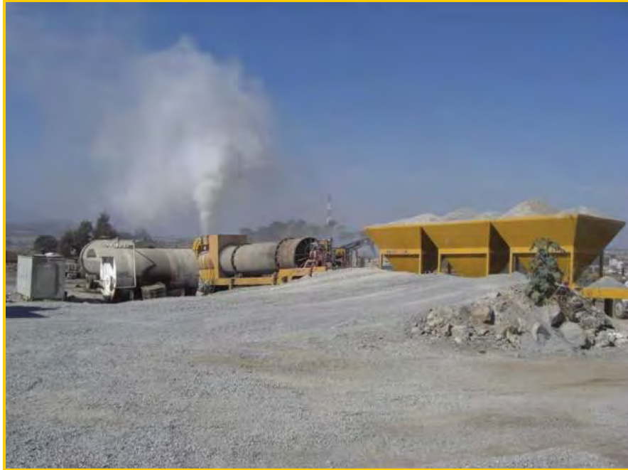
Fig. 6.19: Planta de mezcla asfáltica de producción continua y flujo paralelo, sin recuperador de polvos.
