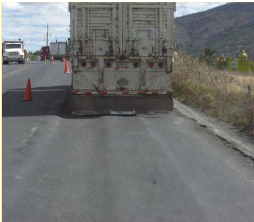
Fig. 6.3: Falla funcional por roderas presentada en el tramo.
