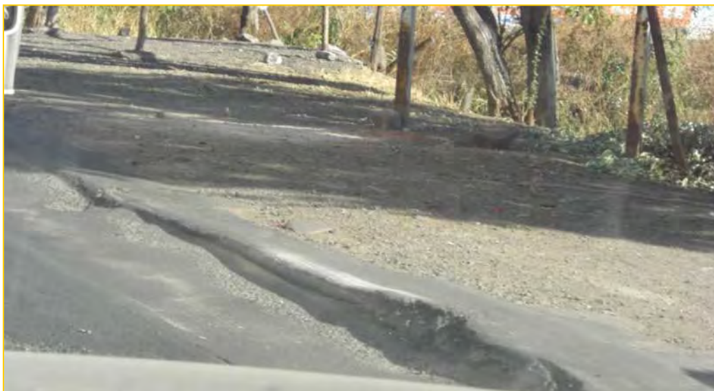
Fig. 6.4: Falla estructural y funcional por deformación de carpeta y capas inferiores.
