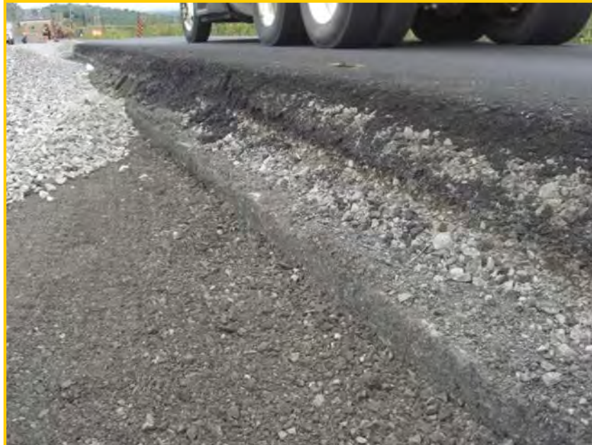
Fig. 6.16: Fresado de pavimento existente inadecuado y puede provocar agrietamiento longitudinal en el pavimento nuevo a largo plazo por el fenómeno de reflexión de grietas.
