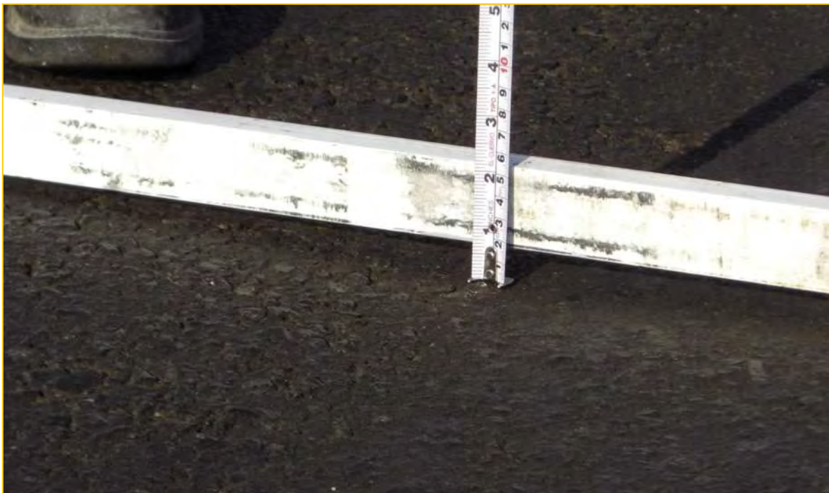
Fig. 6.84: Deformaciones hasta de 1.8cm en las juntas longitudinales.
