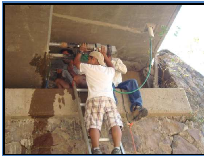
Foto VI.10 Extracción de núcleos, trabe del Puente “El Cayaco” Lázaro Cárdenas, Michoacán. (04/JUN/2011).
