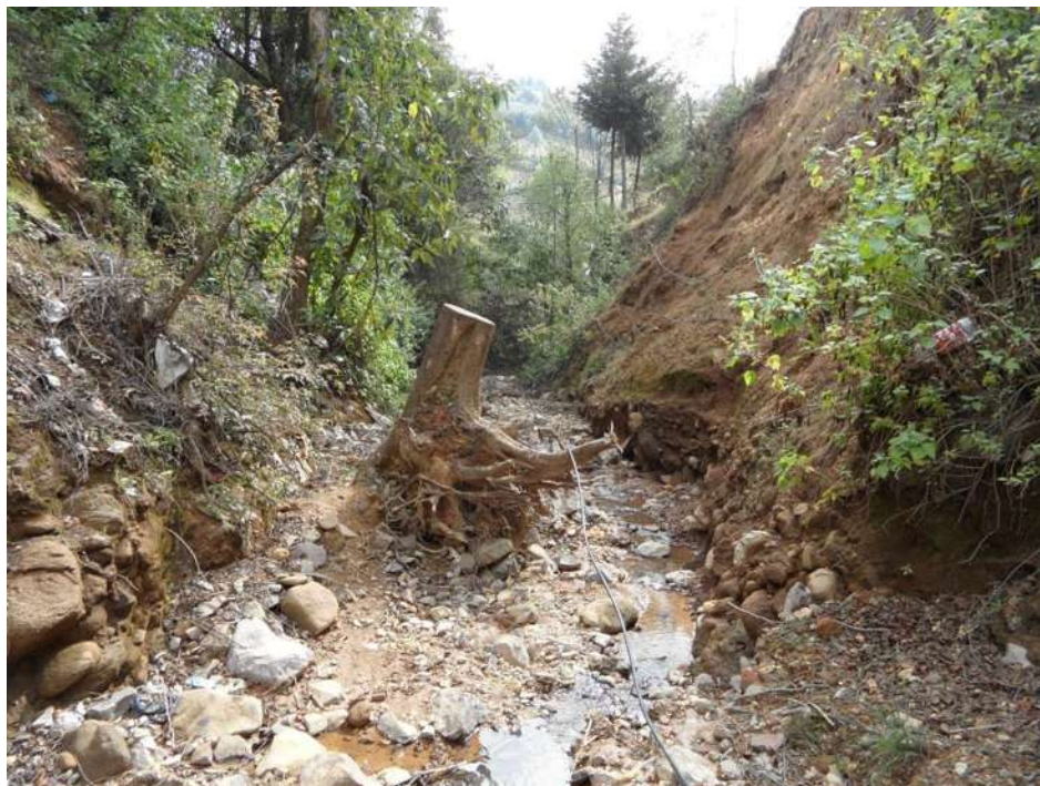
Imagen 42. Vista hacia aguas abajo, donde se observa la erosión del cauce aguas arriba de la losa nueva.
