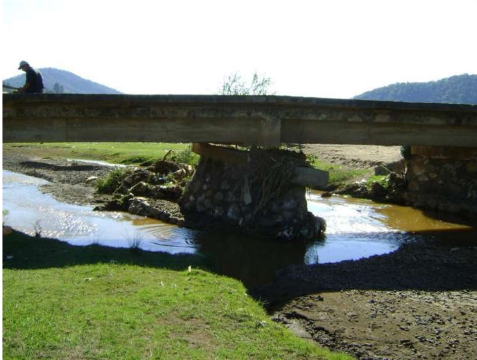
Imagen 44. Puente dañado, se puede observar el grado de afectación en la pila central.
