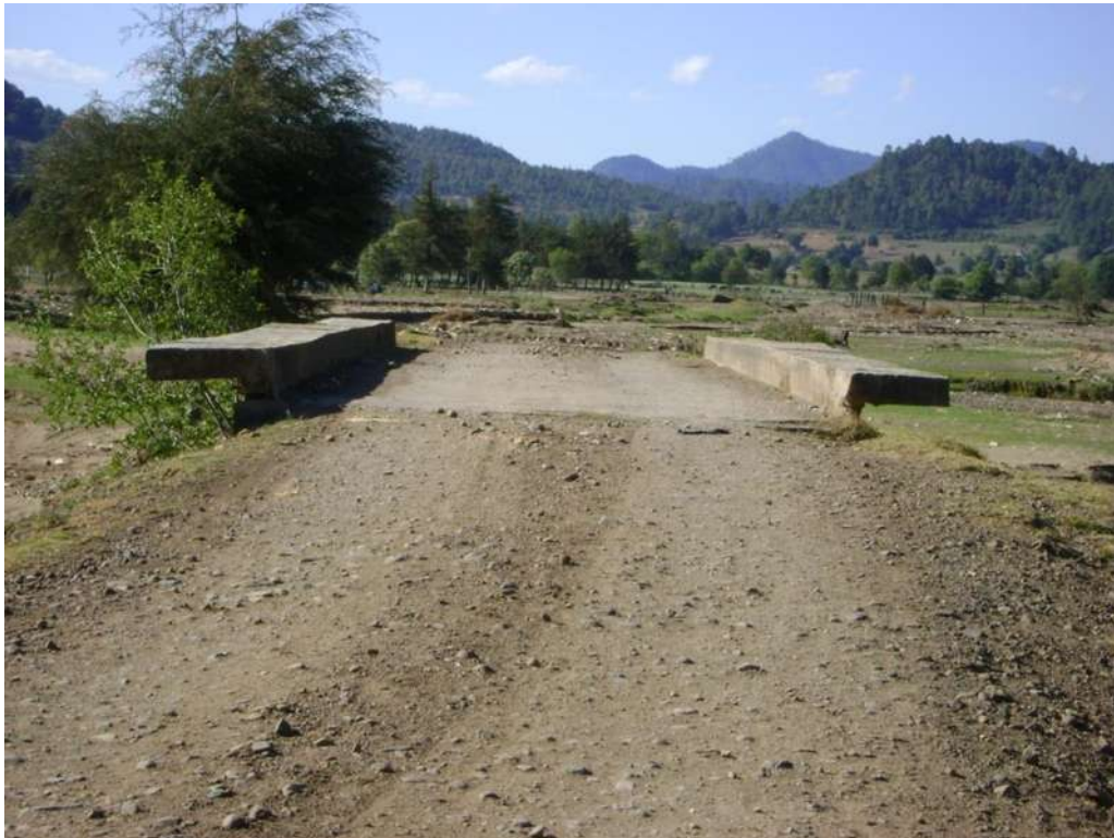
Imagen 43. Puente dañado en febrero del 2010.
