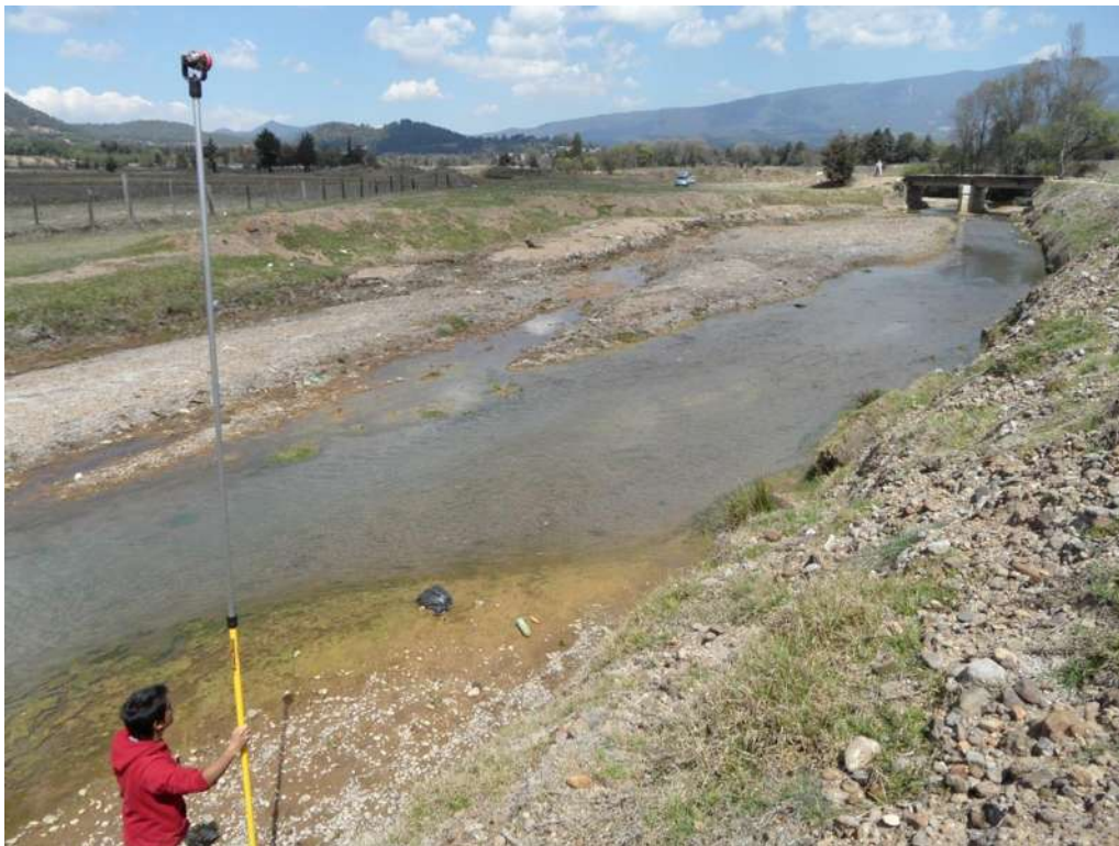
Imagen 54. Imagen aguas abajo del puente, donde se aprecia los materiales sedimentados a la salida.
