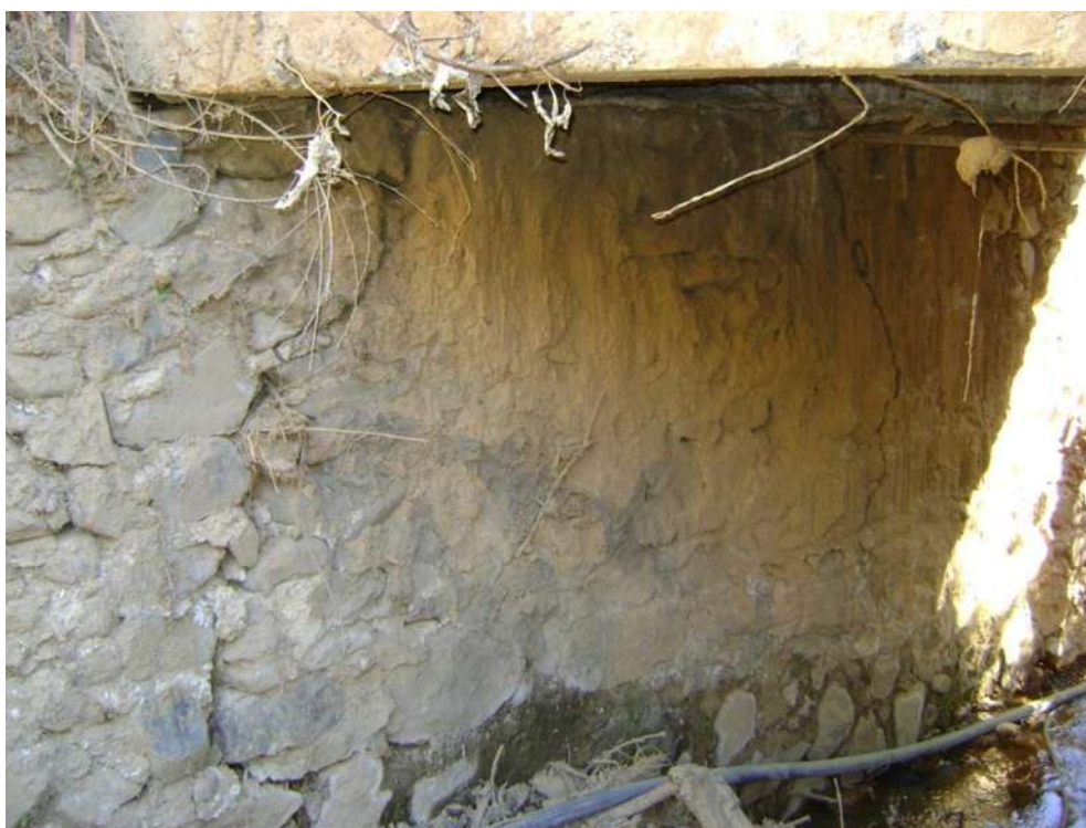
Imagen 34. Uno de los estribos de la Obra de Drenaje, se puede observar el daño que presenta debido a una posible socavación.
