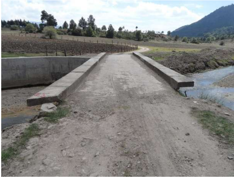
Imagen 49. Imagen del puente reparado, se puede observar que la rasante no se modificó, así como la carencia de sus parapetos de protección.
