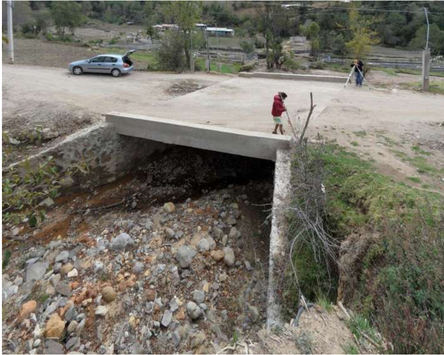
Imagen 37. Panorama aguas abajo donde se aprecia la entrada de la nueva losa.
