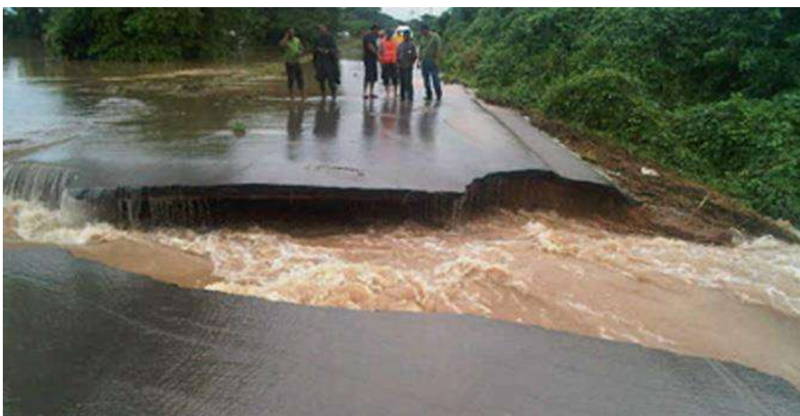
Imagen 1. Obra de drenaje colapsada.
