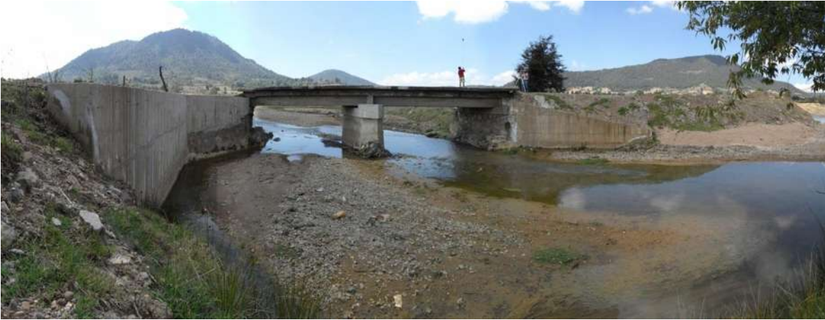
Imagen 51. Panorama aguas abajo donde se aprecia la entrada y la pila reparada del puente, así como el tipo de material sedimentado a la entrada.
