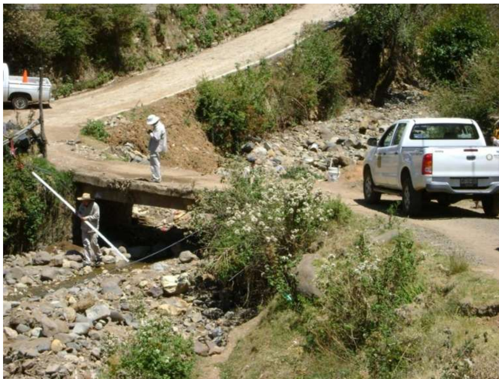
Imagen 19. Imagen de la Obra de Drenaje Dañada en febrero del 2010.
