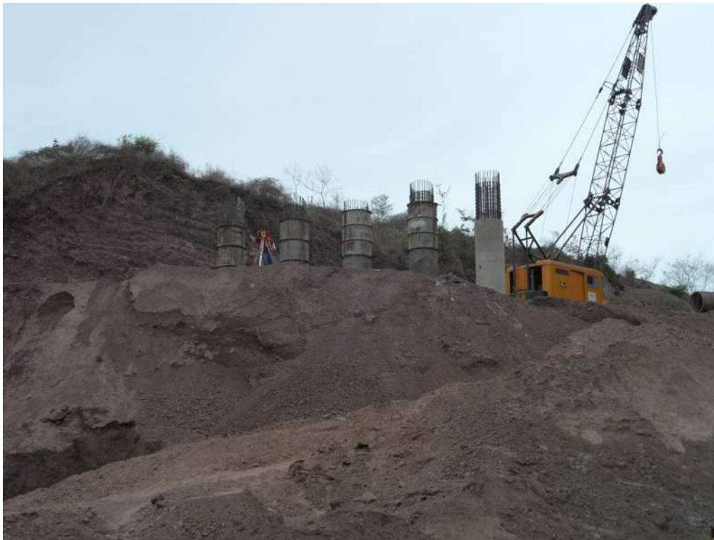
Imagen 81. Vista del terraplen y estribo de acceso (hacia Manzanillo) del puente El Rangel.
