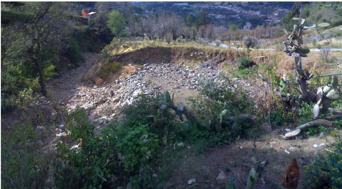
Imagen 26. Vista aguas debajo de la Obra de Drenaje, donde se puede apreciar la erosión del talud derecho del cauce.
