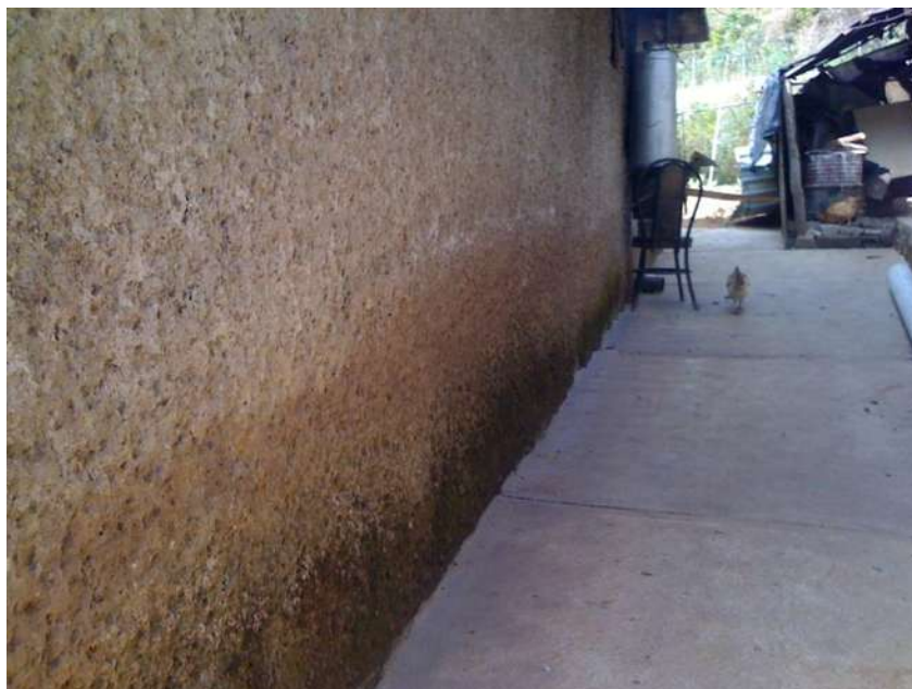
Imagen 27. Vista de la casa del Sr. José Luis Estrada, su casa esta situada en la margen derecha del cauce a la altura de la Obra de Drenaje y existen marcas de la inundación que sufrió teniendo una altura aproximada de 1 metro.
