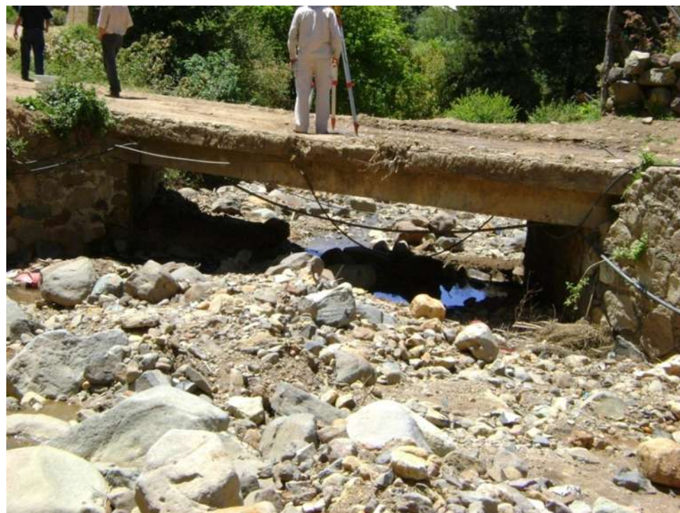
Imagen 20. Imagen de la Obra de Drenaje azolvada prácticamente en un 80% con material de arrastre.
