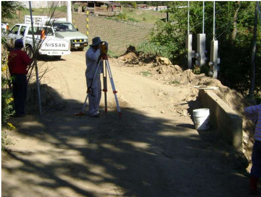
Imagen 32. Obra de Drenaje Dañada en febrero del 2010.
