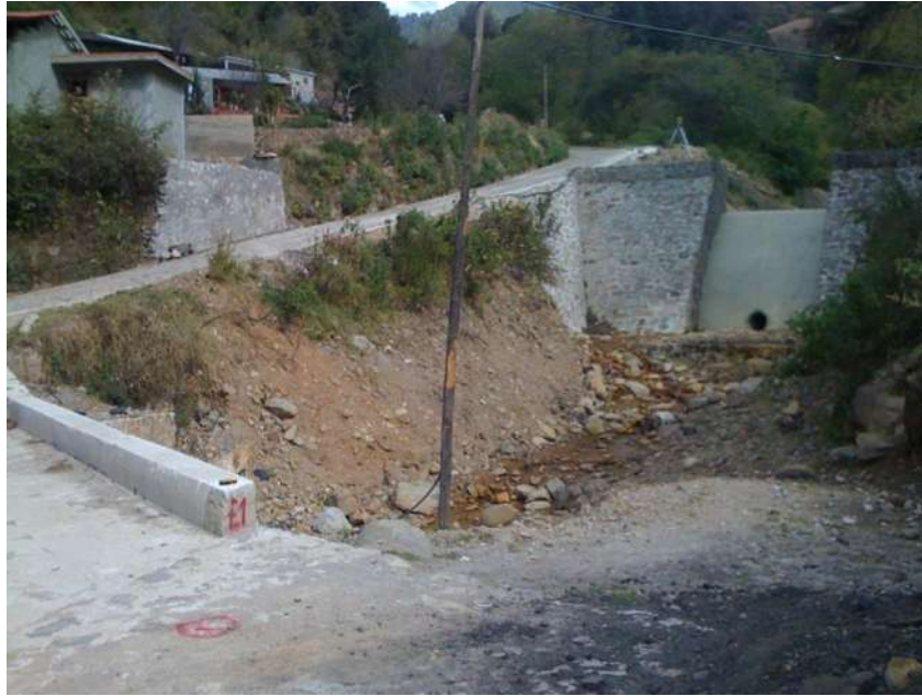
Imagen 23. Vista la Losa y de la Presa Rompe Picos situada aguas arriba.
