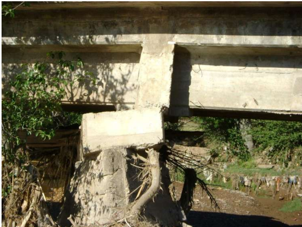
Imagen 45. Pila Central con severo daño de socavación.
