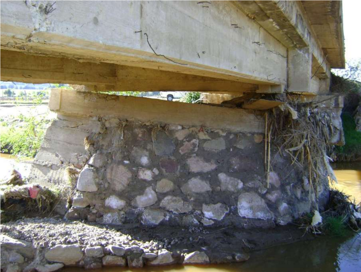
Imagen 46. Vista a detalle del hundimiento diferencial de la pila central, debido a la socavación en la entrada del puente al no presentar el área hidráulica suficiente.
