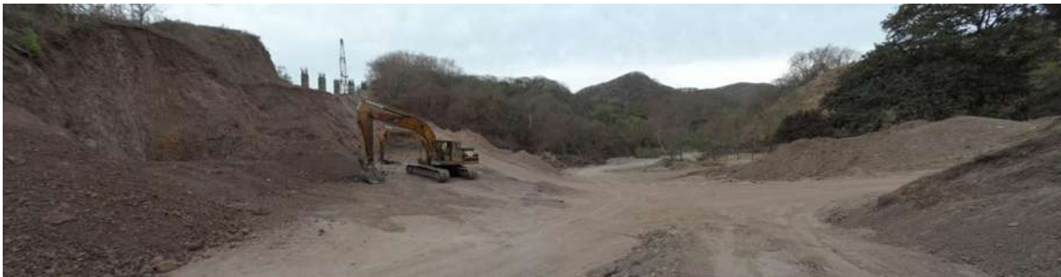
Imagen 83. Panorama aguas arriba del puente El Rangel (nuevo) en proceso de construcción.
