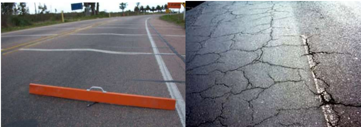
Figura 2.1. Ejemplos de fallas en pavimentos flexibles.
