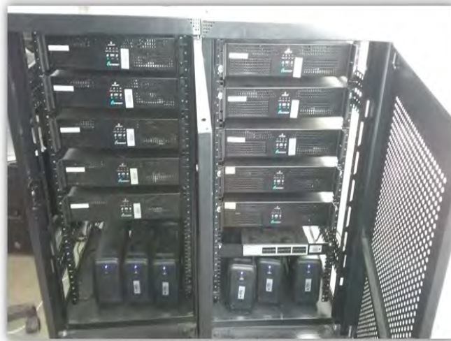
Figura 3.8. Estaciones de trabajo del cluster de cálculo construido para el trabajo de optimización
