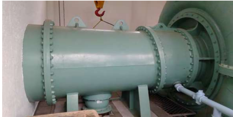
Figura 1.6. Cono del tubo de aspiración intercambiable de la Turbina Francis de la C.H. Cointzio.
