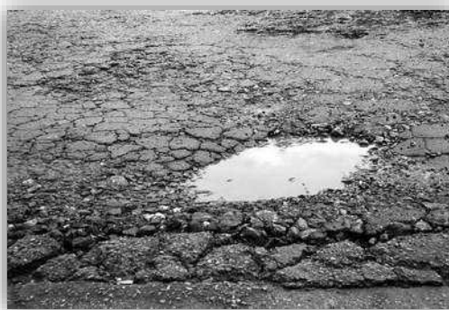
Figura B.1. Bache en pavimento flexible.
