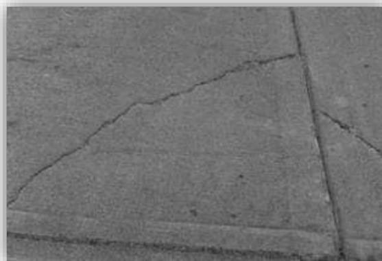
Figura B.10. Grieta de esquina.
