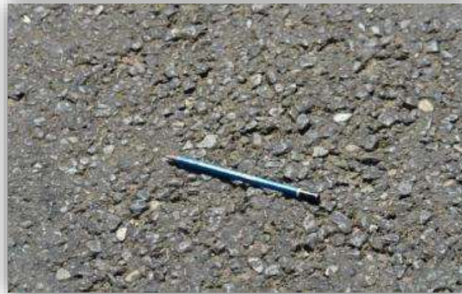
Figura B.3. Desprendimiento del agregado.
