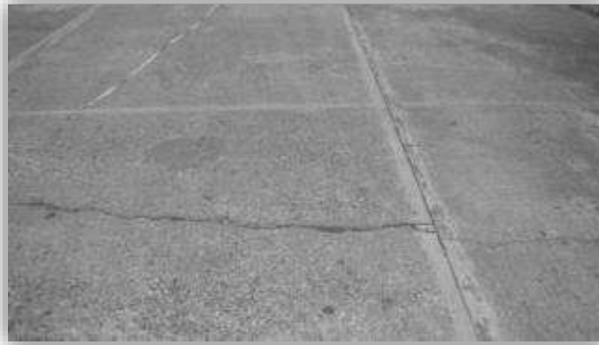
Figura B.14. Grieta transversal.
