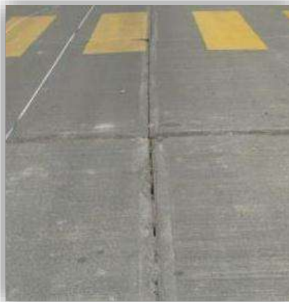
Figura B.5. Deficiencias del sellado.
