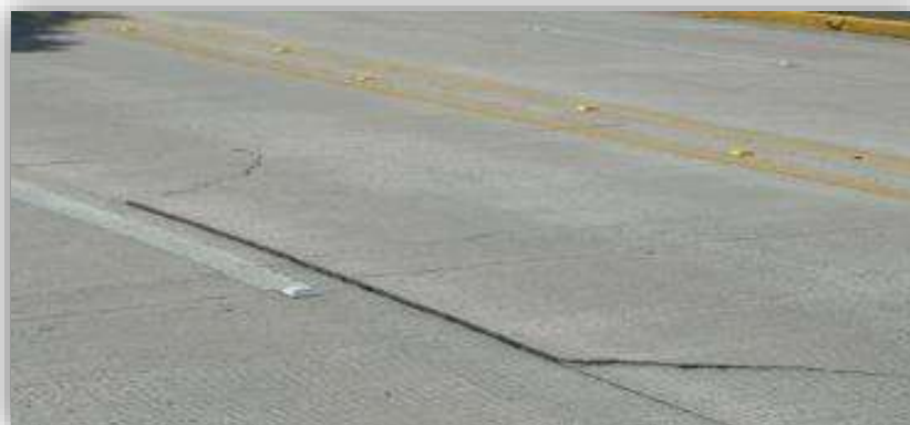
Figura B.20. Escalonamiento en junta.
