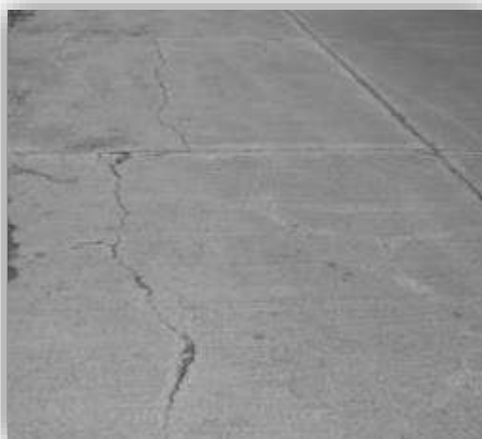
Figura B.12. Grieta longitudinal.
