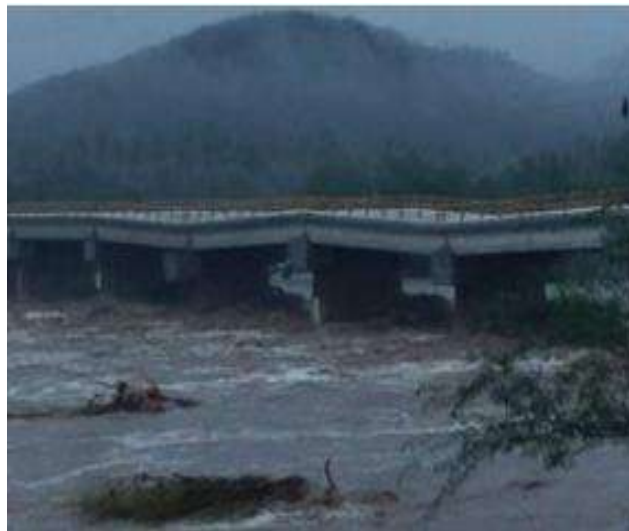
Figura 1.5 Daños en el puente del tramo carretero Oaxaca-Tehuantepec.
