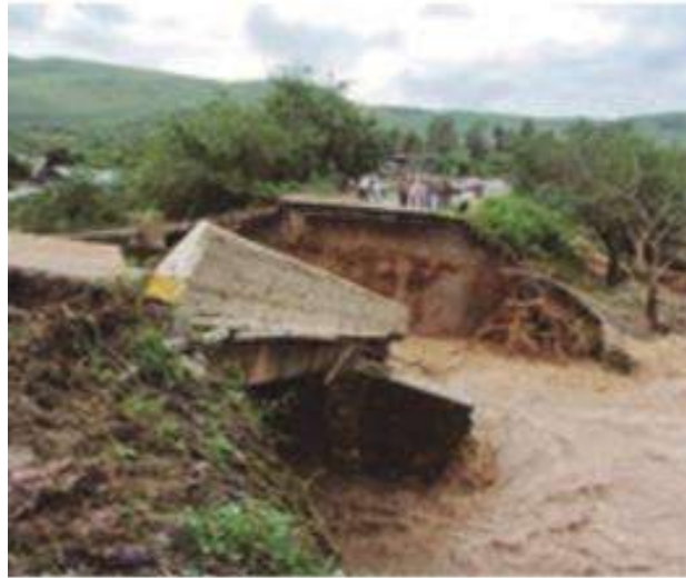
Figura.1.4 Socavación del puente petaquillas
