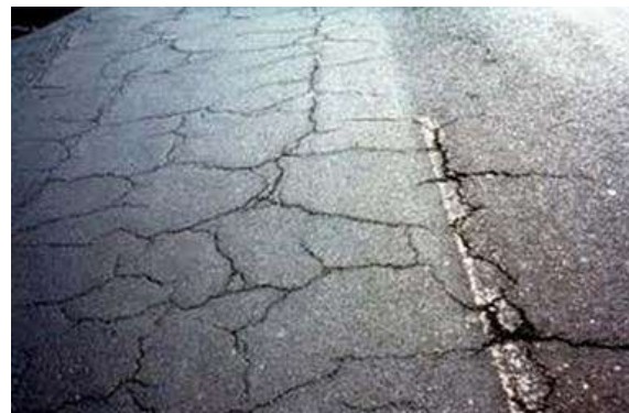
Figura 8.- Falla por Fatiga de la Carpeta Asfáltica.
