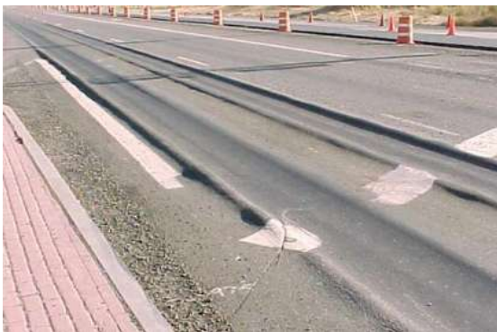
Figura 7.- Falla por Deformación Permanente.
