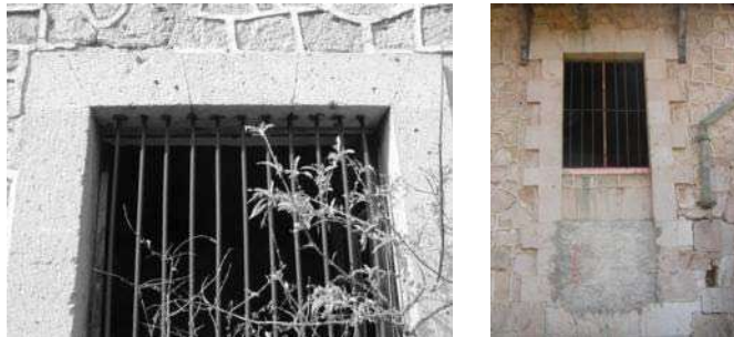
Foto de herrería del edificio B planta baja. Fotografía Yunuén Y. Barrios Muñoz.
