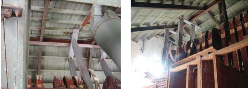
Fotos Estructura de la cubierta del edificio A. Fotografía Yunuén Y. Barrios Muñoz.
