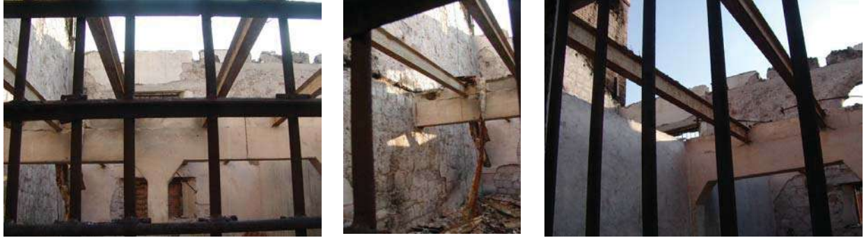
Fotos de alteración espacial, edificio B , posterior al incendio. Fotografía Yunuén Y. Barrios Muñoz. Abril del 2006.
