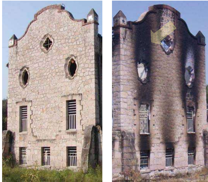
Fotos de la fachada oriente antes del incendio y posterior al incendio. Obsérvese la grieta que aparece en el vano Fotografía Yunuén Y. Barrios Muñoz. Diciembre del 2005 y Abril del 2006.
