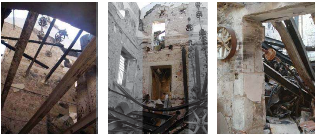
Fotos de alteración espacial edificio A , posterior al incendio. Fotografía Yunuén Y. Barrios Muñoz. Abril del 2006.
