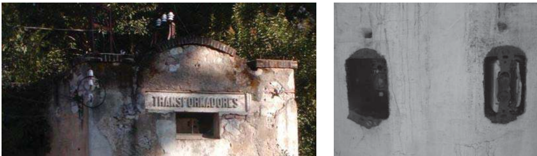
Fotos del edificio de los transformadores y de los apagadores y contactos del edificio A. Fotografía Yunuén Y. Barrios Muñoz.
