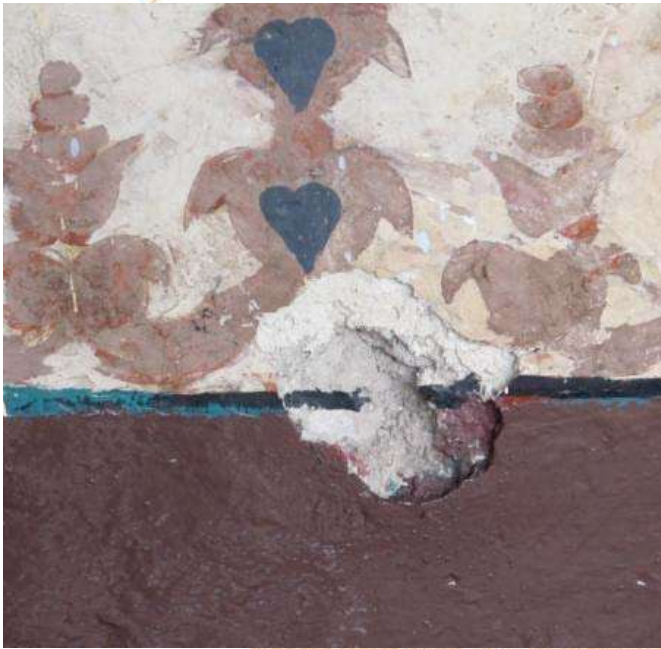
Figura No. 33: Muestra el estado deteriorado y la pérdida de aplanados. Foto: E. L. Torres, P. C., 2010.
