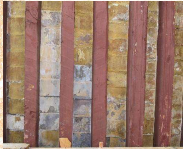
Figura No. 36: Muestra las manchas y el deterioro por humedad que presenta el sistema de terrado. Foto: E. L. Torres, P. C., 2010.
