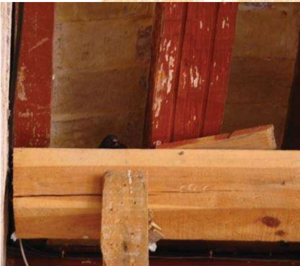
Figura No. 35: Muestra el estado deteriorado de las vigas cerca de las cabezas. Foto: A. Murillo, G., 2010.
