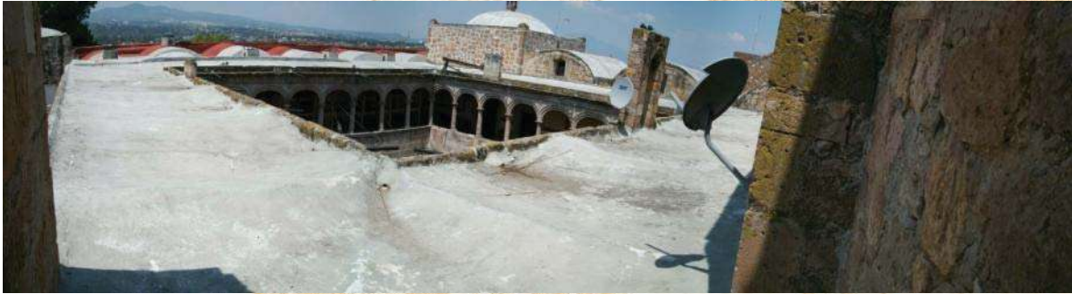
Figura No. 38: Muestra la falta de mantenimiento que presentan las bajadas y el problema de falta de impermeabilizante. Foto: E. L. Torres, P. C., 2010.
