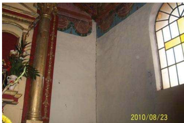
IMAGEN 86.- Agrietamiento en la esquina sureste del interior del Templo. (Foto: J.A.P.I, agosto 2010)
