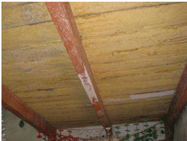
IMAGEN 91.- Deflexión de vigas en coro y craquelado en la cubierta de tablón. (Foto: J.A.P.I, agosto 2010)
