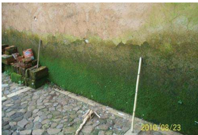
IMAGEN 90.- Aparición de musgo en el inferior del muro exterior sur.(Foto: J.A.P.I, agosto 2010)
