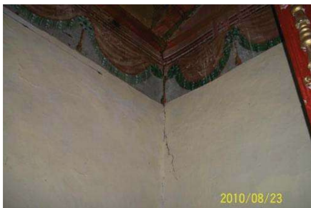
IMAGEN 85.- Agrietamiento en la esquina noreste del interior del Templo. (Foto: J.A.P.I, agosto 2010)
