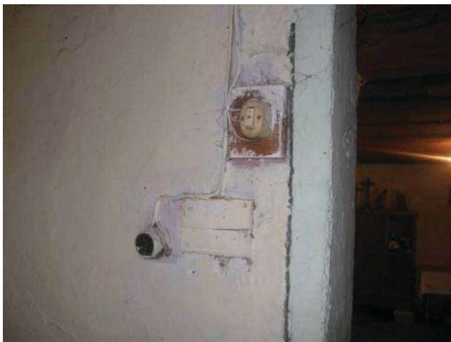
IMAGEN 81.- Vista de los apagadores y contactos ubicados a un costado del acceso a la sacristía. (Foto: J.A.P.I, agosto 2010)
