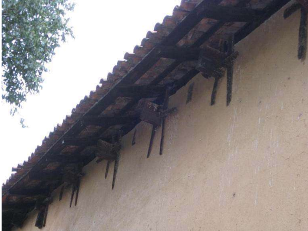
IMAGEN 18.- Sistema de tensores en a nivel de la cubierta del Templo. (Foto, J.A.P.I, noviembre 2009.)
