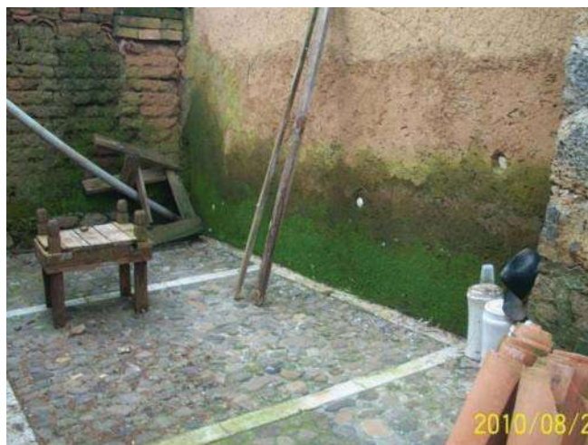
IMAGEN 31.-Intervención realizada en 2007, colocación de aerodren y banqueta de piedra bola. (Foto: J.A.P.I, agosto 2010)
