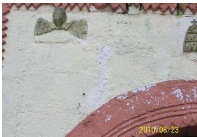
IMAGEN 83.- Alfiz con aparentes grietas que han sido cubiertas estéticamente. (Foto: J.A.P.I, agosto 2010)
