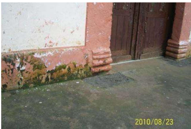
IMAGEN 89.- Desprendimiento de aplanados y pintura debido a la humedad. (Foto: J.A.P.I, agosto 2010)
