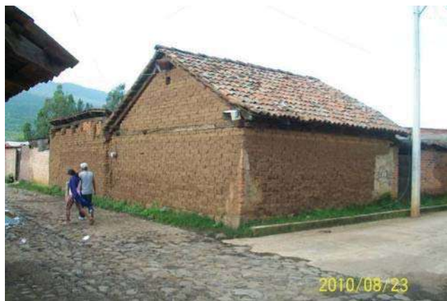
IMAGEN 45.- Existen construcciones sin ningún tipo de aplandado en Santo Tomás. (Foto: J.A.P.I, agosto 2010)
