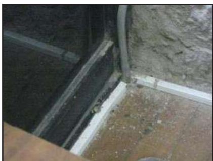
Imagen 138: Se observa tierra que cae del entepiso en el corredor sur del segundo patio y en la sala de maestros. (Foto: José A. Morales A.)
