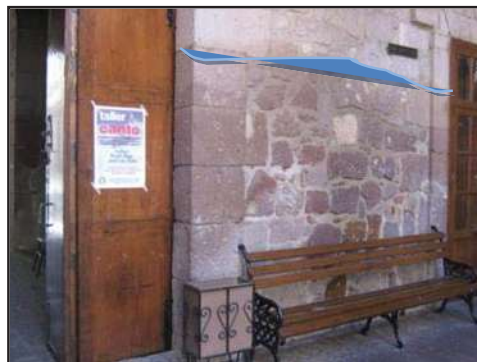
Imagen 151: Presencia de humedad y sales y los muros interiores a una altura de hasta 2.00 mts(Foto: José A. Morales A.)
