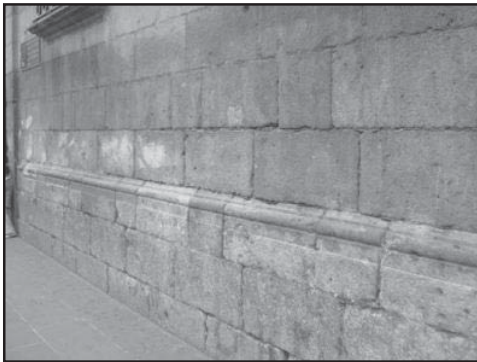
Imagen 157: disgregación en mampostería y juntas de la portada norte, presencia de suciedad (Foto: José A. Morales A.)
