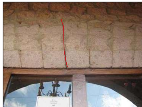
Imagen 145.: fisura 6 en los muros del corredor oriente, primer patio planta alta. De forma diagonal. Foto: José Antonio Morales Arriaga.
