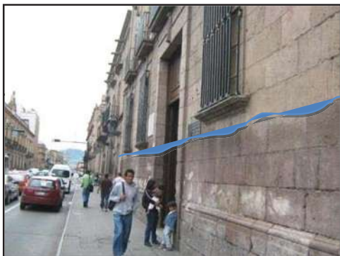
Imagen 150: Presencia de humedad y sales y pérdida de juntas y los muros de la fachada principal a una de 2.80 mts., (Foto: José A. Morales A.)
