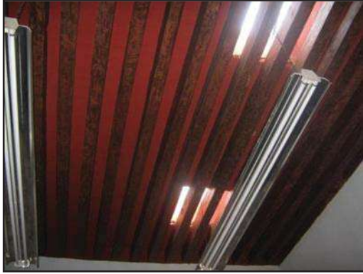
Imagen 88: Se observa el uso domos para la iluminación natural de aula: (Foto: José A. Morales A.)
