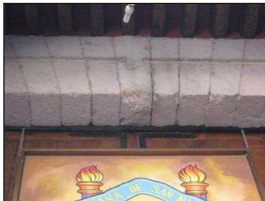
Imagen 149: pérdida de juntas entre dovelas de la platabanda de los corredores en p.b. (Foto: José A. Morales A.)
