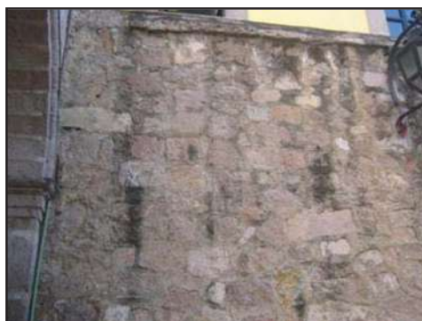
Imagen 159: Presencia de algas en donde se presentan los escurrimientos barda del segundo patio (Foto: José A. Morales A.)
