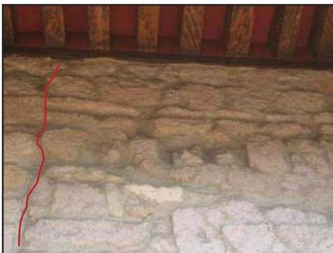
Imagen 144.: fisura 5 en los muros del corredor oriente, primer patio planta alta. De forma diagonal. (Foto: José Antonio Morales Arriaga.)
