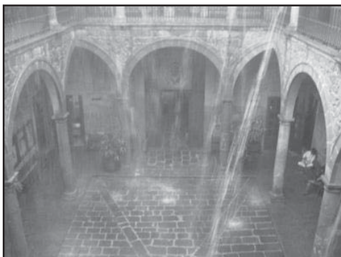
Imagen 154: Esgurrimientos de las aguas pluviales hacia el 1er patio se observan salpicamientos hacia los apoyos (Foto: José A. Morales A.)
