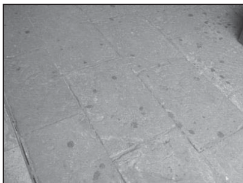
Imagen 160: Se observa el desgaste del piso de baldosa de cantería en el área de acceso al inmueble (Foto: José A. Morales A.)
