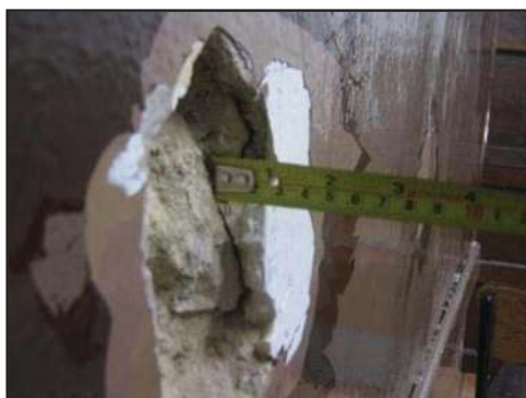
Imagen 161: Se observan perdida de aplanados en muros en las aulas (Foto: José A. Morales A.)
