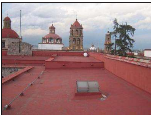
Imagen 58: panorámica de la azotea, se observa el ramaleo de la distribución de la instalación eléctrica. (Foto: José A. Morales A.)
