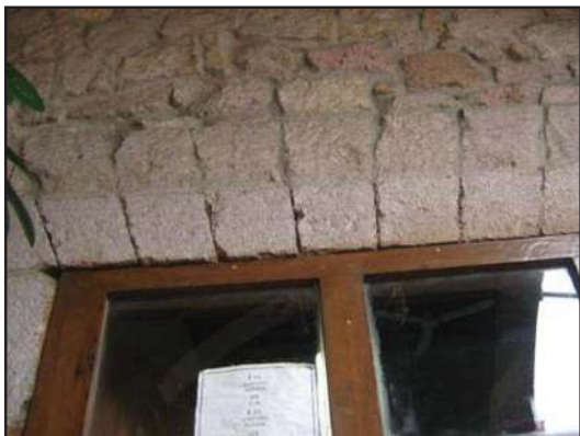
Imagen 148: pérdida de juntas entre dovelas de la platabanda de los corredores en planta alta. (Foto: José A. Morales A.)
