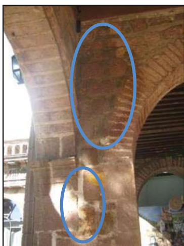
Imagen 152: Presencia de humedad y sales en la 1er pilastra del corredor oriente del segundo patio, por una bajante de aguas pluviales, (Foto: José A. Morales A.)
