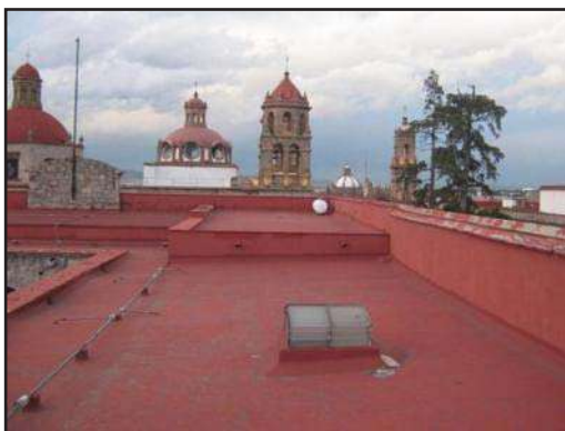
Imagen 122: Foto panorámica de la azotea, se observa el ramaleo de la distribución de la instalación eléctrica. (Foto: José Antonio Morales A.)
