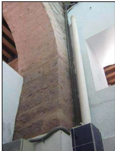
Imagen 120: Foto donde se observa la bajada de aguas negras de los baños del segundo piso. (Foto: José Antonio Morales A.)
