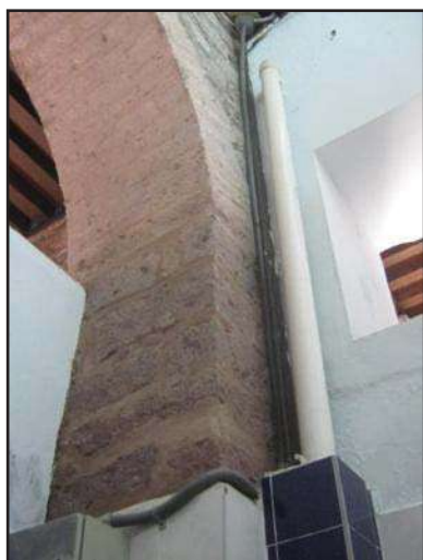
Imagen 56: donde se observa la bajada de aguas negras de los baños del segundo piso. (Foto: José A. Morales A.)
