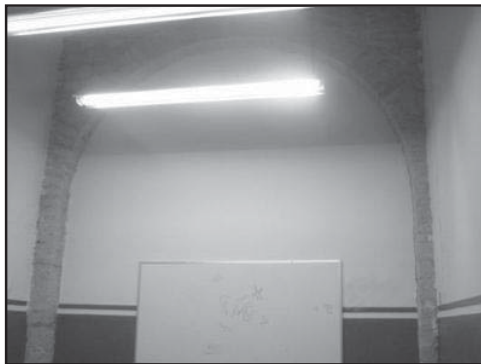
Imagen 164: Se divide el espacio del corredor este del segundo patio, se observa falta de iluminación. (Foto: José A. Morales A.)
