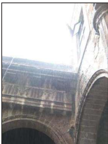
Imagen 156: Esgurrimientos por el entablamento del segundo patio debido a la pérdida de elementos y a la falta de mantenimiento (Foto: José A. Morales A.)
