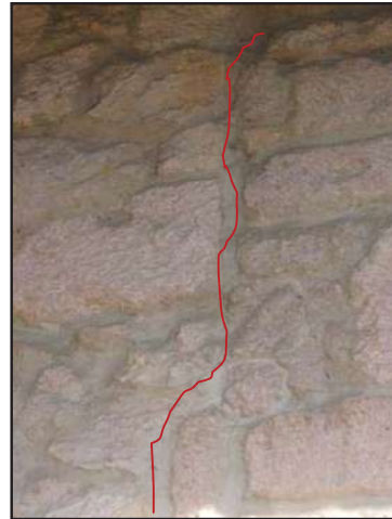
Imagen 143: fisura 4 en los muros del corredor oriente, primer patio planta alta. De forma diagonal. (Foto: José Antonio Morales Arriaga.)
