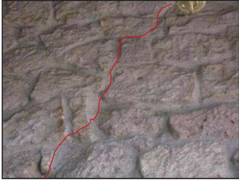
Imagen 142: fisura 3 en los muros del corredor oriente, primer patio planta alta. De forma diagonal. (Foto: José Antonio Morales Arriaga.)
