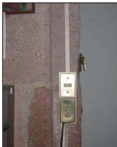
Imagen 123: Foto interior, donde se observa la colocación y fijación de contacto y apagador sobre muro, en canaleta de plástico. (Foto: José Antonio Morales A.)
