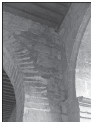
Imagen 166: Se observa humedad en los apoyos causa de la bajante del baño de planta alta. (Foto: José A. Morales A.)
