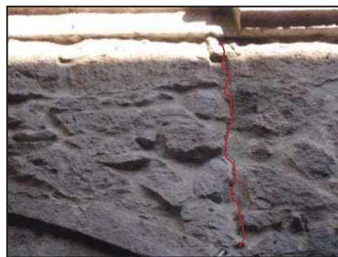
Imagen 141: fisura 2 en los muros del corredor oriente, primer patio planta baja. Se observa un cuatrapeo inadecuado. (Foto: José Antonio Morales Arriaga.)
