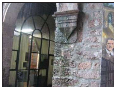
Imagen 153: Escurrimientos en elementos de cantería, provocando la presencia de micro flora, (Foto: José A. Morales A.)
