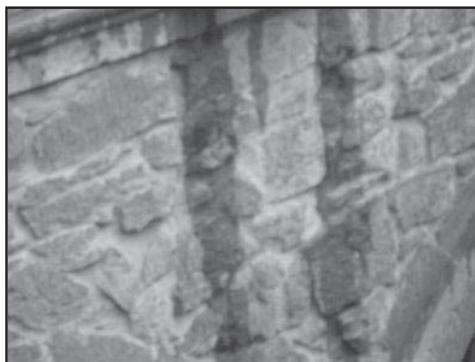
Imagen 155: Esgurrimientos por las cornisas debido a la pérdida de elementos y a la falta de mantenimiento (Foto: José A. Morales A.)
