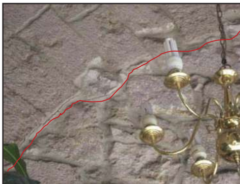
Imagen 140: fisura 1 en los muros del corredor oriente, primer patio planta baja. se observa una separación de la mampostería, diferentes resistencias. (Foto: José Antonio morales arriaga.)
