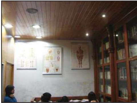
Imagen 163: Se observa la humedad en muros y la colocación de una vitrina de madera junto al muro (Foto: José A. Morales A.)
