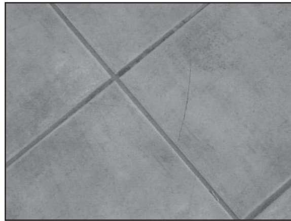
Imagen 147: fisura 7 en pisos del pasillo sur, planta alta. (Foto: José Antonio Morales Arriaga.)
