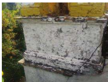
Figura 55. Deterioros en el primer cuerpo de la torre. Foto: MRBR.
