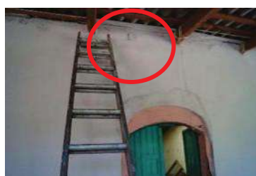
Figura 19. Colocación de Hobo en exterior de sacristía. Foto: MRBR.
