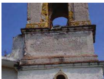
Figura 57. Deterioros en elementos ornamentales de torre. Foto: MRBR.
