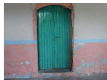
Figura 59. Deterioros en pintura en los exteriores de sacristía y bodega. Foto: MRBR.
