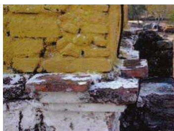
Figura 58. Deterioros en elementos ornamentales de torre (ampliación). Foto: MRBR.
