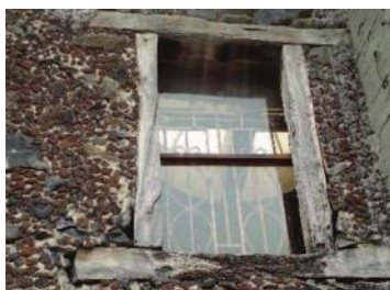
Figura 29. Cerramiento a base de dintel de madera en exterior de la nave. Foto: MRBR.
