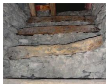
Figura 44. Escalera deteriorada en el basamento del interior de la torre. Foto: MRBR.
