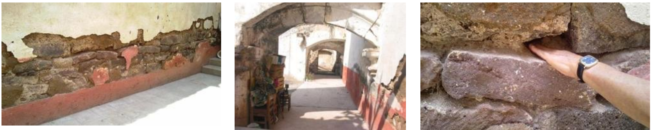
Ilustración 50. Desprendimiento de aplanados por la parte exterior del muro sur del templo Fuente: Fotografía del autor. 2012
