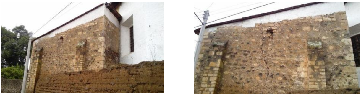
Ilustración 52. Fracturas en exterior de sacristía. Fuente: Fotografía del autor. 2012
