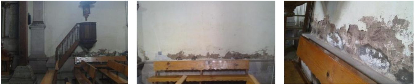
Ilustración 49. Desprendimiento de aplanados en la parte superior del guardapolvo, al interior del muro sur del templo Fuente: Fotografía del autor. 2012
