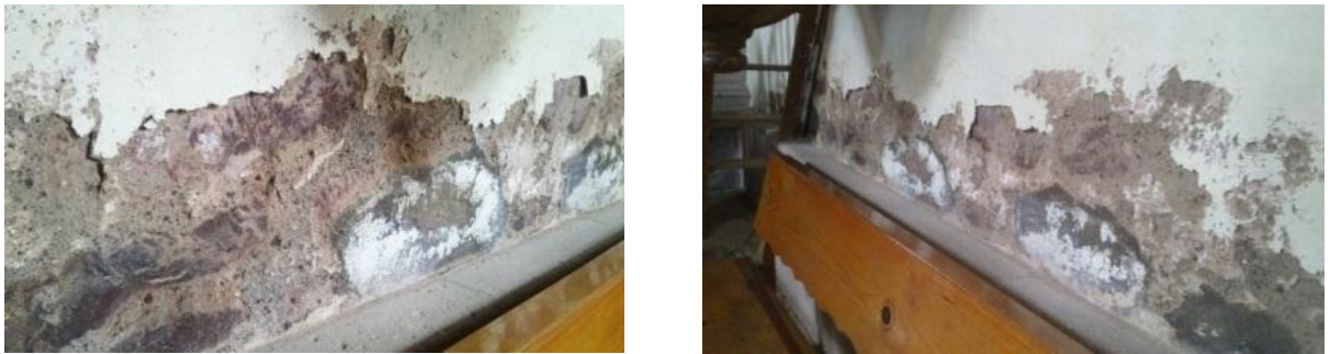
Ilustración 57. Transmision de humedad. Vista interior de muro sur. Fuente: Fotografía del autor. 2012
