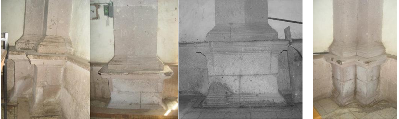
Ilustración 51. Estado de deterioro de pilastras de Eje 14. Fuente: Fotografía del autor. 2012
