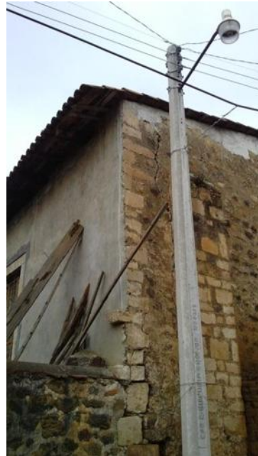
Ilustración 53. Fracturas en exterior de sacristía. Fuente: Fotografía del autor. 2012
