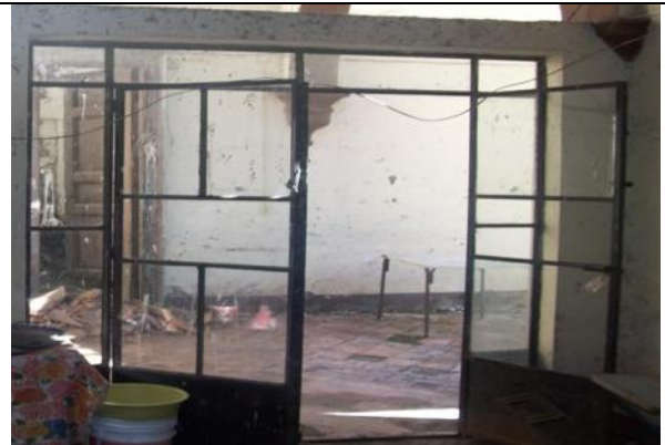
Imagen 217.- Vista de la herrería de perfil ángulo para división con el patio.
