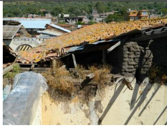
Imagen 258.- Presencia de flora sobre las cubiertas.
