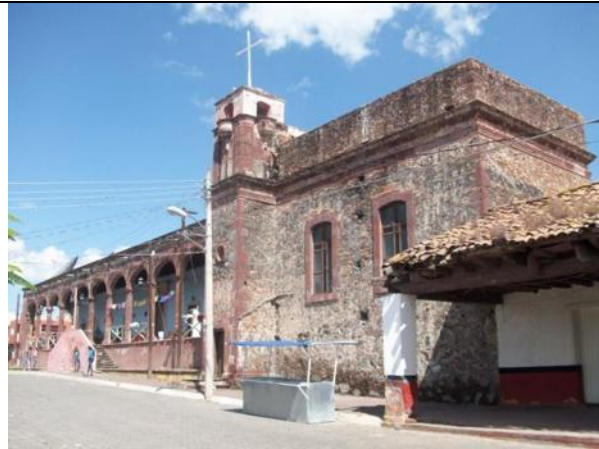
Imagen 236.- Mutilación del alero en fachada ppal.
