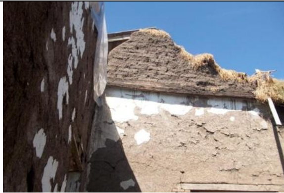
Imagen 253.- Vista de la pérdida total de la cubierta.
