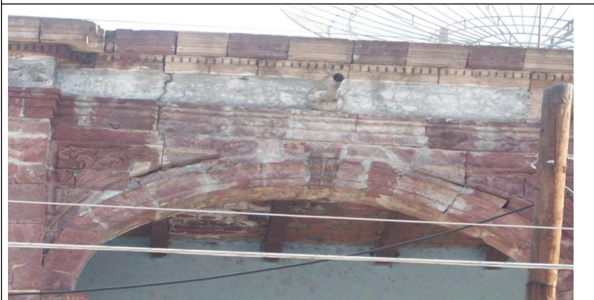
Imagen 247a.- Vista de las grietas que se generaron en los elementos de cantería del portal de la fachada principal.
