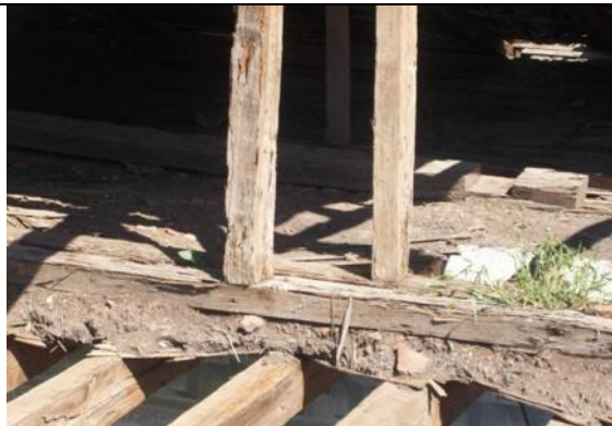
Imagen 255.- Vista de la pérdida total de la cubierta y la tapa de baldosa.
