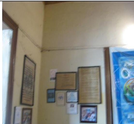
Imagen 207.- Instalación eléctrica visible en sala.
