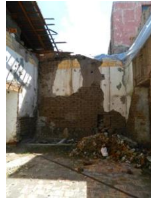
Imagen 055 .- Vista interior donde se percibe la pérdida de la cubierta.
