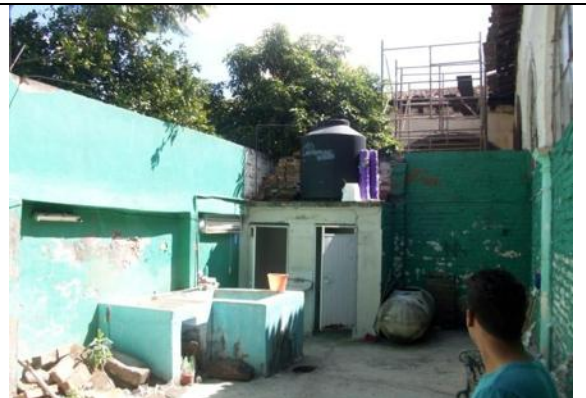
Imagen 201.- Instalación hidráulica y su almacenamiento en pila y tinaco.
