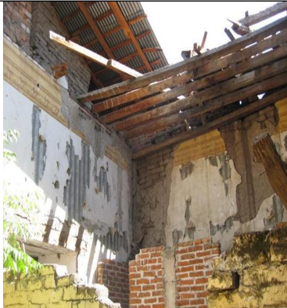
Imagen 263.- El apolillamiento de varios rollizos de madera.
