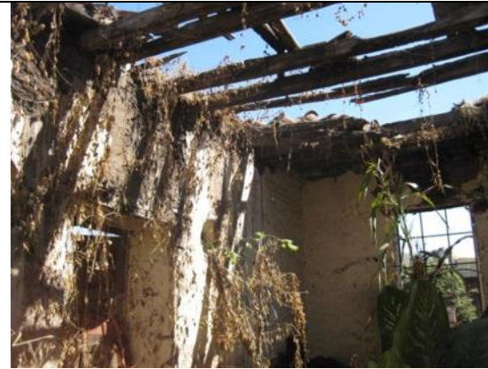
Imagen 262.- El apolillamiento de varios rollizos de madera.
