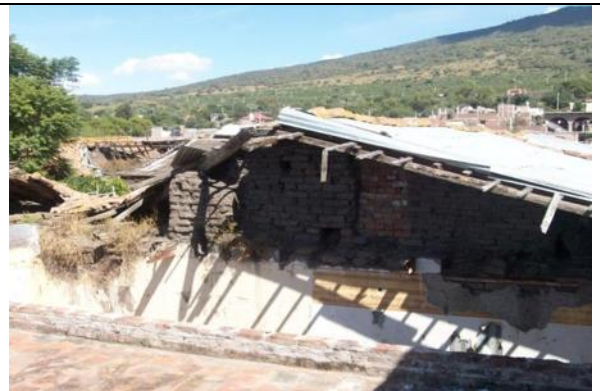
Imagen 256.- Vista de la pérdida total de la cubierta y la tapa de baldosa.
