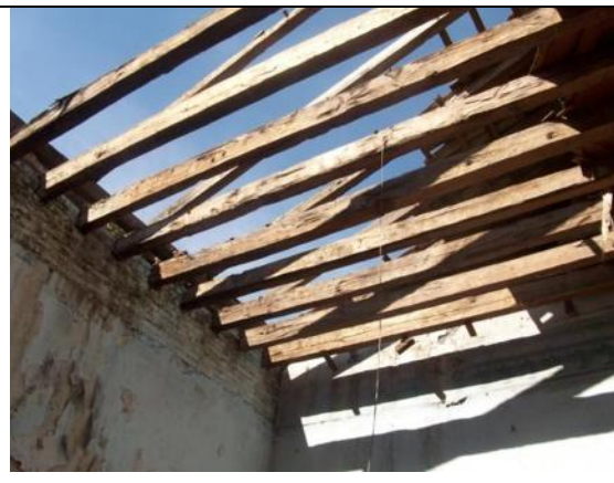
Imagen 260.- Daño sobre la vigería del entrepiso.
