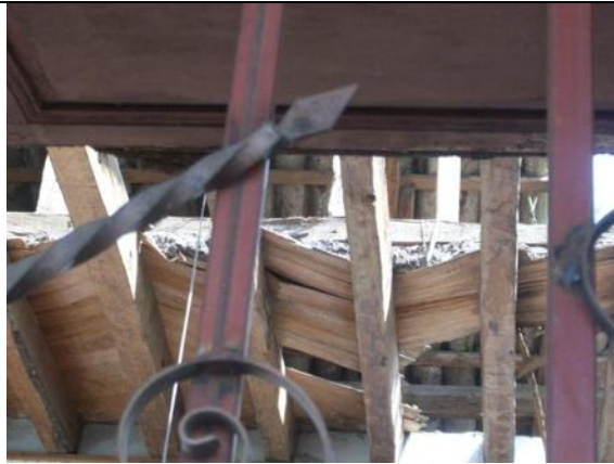
Imagen 261.- El apolillamiento de varios rollizos de madera.
