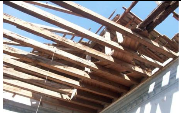
Imagen 254.- Vista de la pérdida total de la cubierta.
