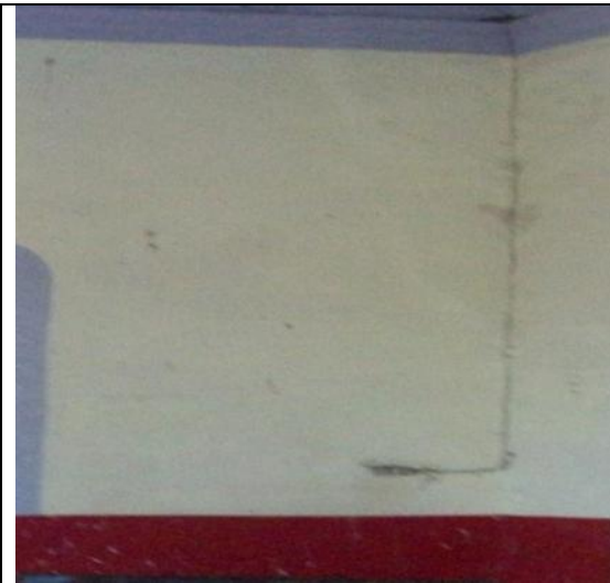
Imagen 206.- Instalación eléctrica visible en capilla.
