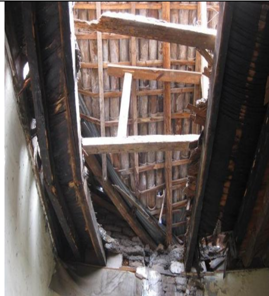
Imagen 264.- El apolillamiento de varios rollizos de madera.
