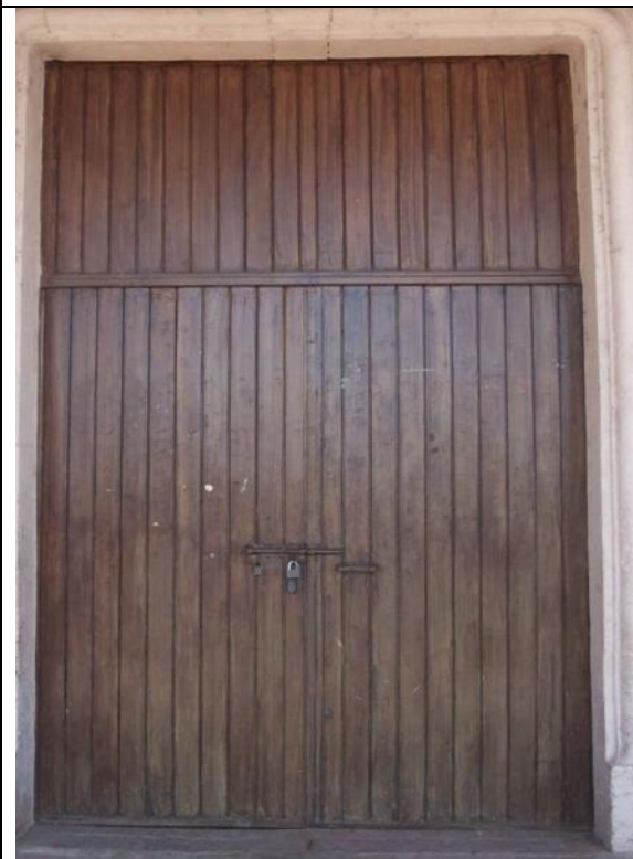
Imagen 218.- Vista de puerta metálica de dos hojas y antepecho, del acceso al zaguán ubicada en el pórtico de la fachada principal.
