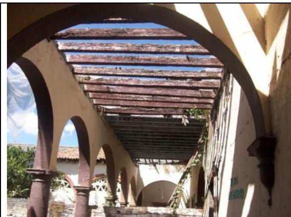
Imagen 259.- Daño sobre la vigería del entrepiso.
