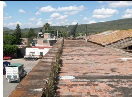
Imagen 257.- Presencia de flora sobre las cubiertas.
