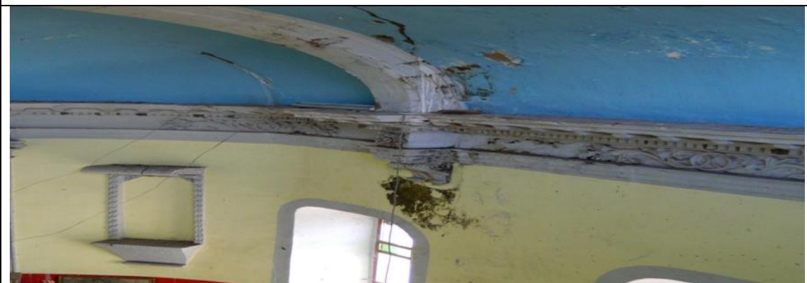
Imagen 248.- Vista de los diferentes elementos estructurales que presentan agrietamientos sobre sus superficies.
