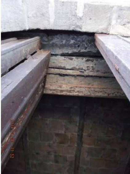
Imagen #28 Estado de la puerta de acceso. Fotografía: María Carol Ramírez Garcidueñas.
