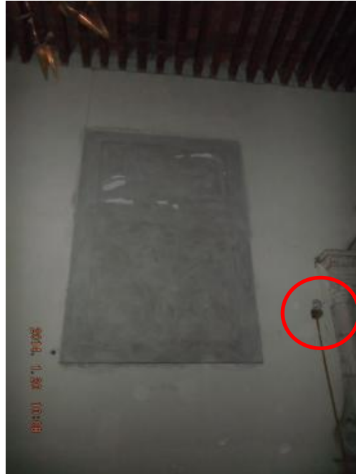
Imagen #66 Focos empotrados en los muros laterales Fotografía: María Carol Ramírez Garcidueñas.
