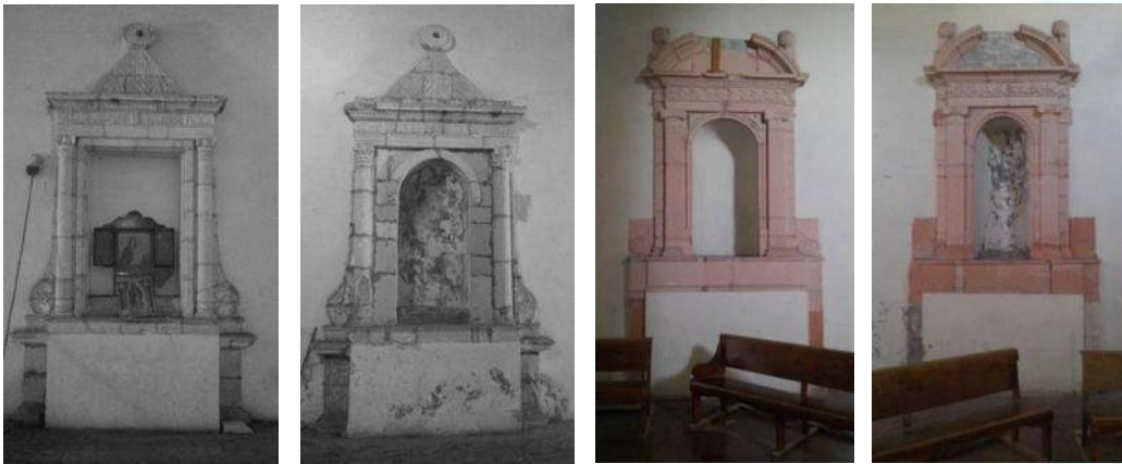
Imagen #37 Estado actual de los retablos laterales.
