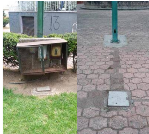
Imagen # 34 Instalación eléctrica de alumbrado público Fotografía: Andrés García Torres
