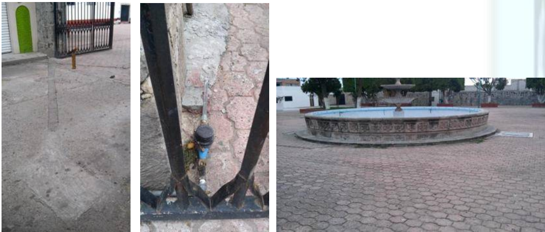
Imagen # 35 Instalación hidráulica general Fotografía: Andrés García Torres
