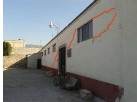
Imagen #42 Grietas en la fachada principal del anexo. Fotografía: María Carol Ramírez Garcidueñas.
