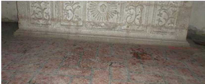
Imagen 23 Suciedad en el piso de la capilla sur, provocada por los desechos de los murciélagos existentes en el inmueble.
