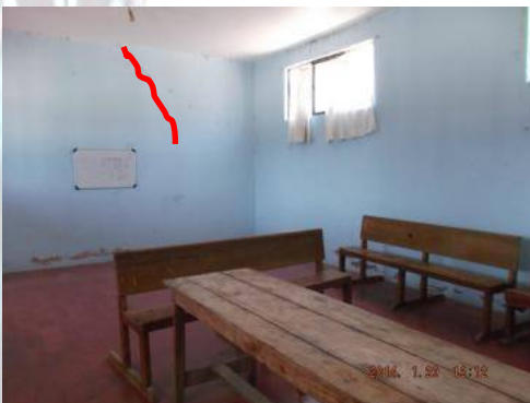
Imagen #43 Presencia de grietas en espacios interiores.
