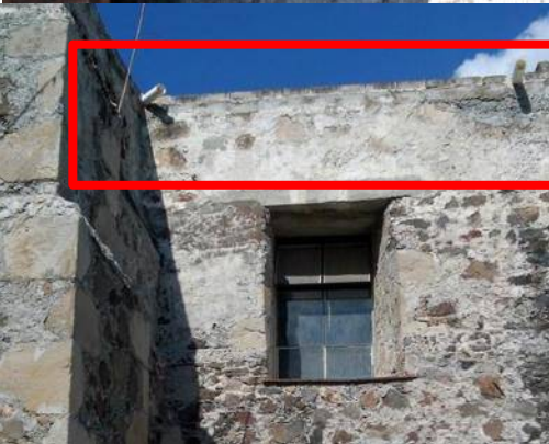
Imagen #94 Bajadas de agua: Gárgolas y PVC Fuente: Andrés García Torres
