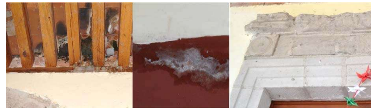
Foto 49. Humedad y costra negra en tejas de la techumbre. MCHB. 23/12/14.
