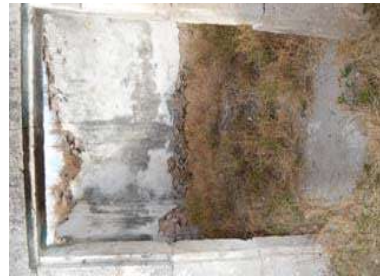
F19_VANO DE LA PUERTA DE ACCESO AL ESPACIO. SE OBSERVA EL RUINOSO. _231214_MCHB
