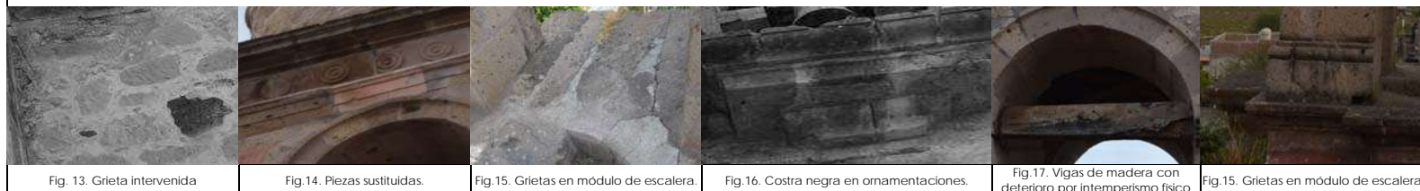
Fig. 13. Grieta intervenida Fig. 14. Piezas sustituidas. Fig. 15. Grietas en módulo de escalera. Fig. 16. Costra negra en ornamentaciones. Fig. 17. Vigas de madera con deterioro por intemperismo físico Fig. 18. Grietas en módulo de escalera
