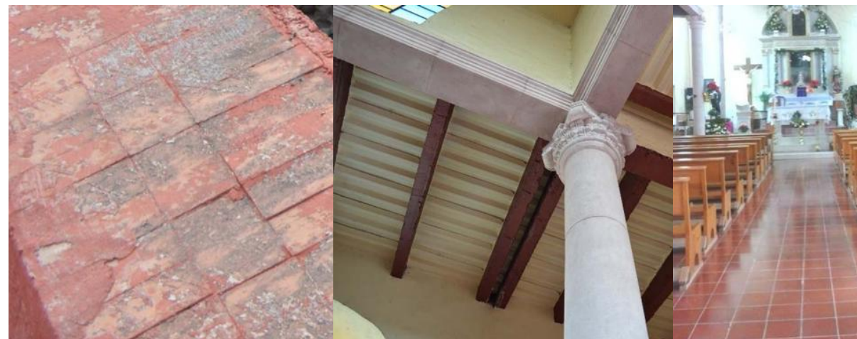
Foto 55. Impermeabilizante acrílico desgastado. MCHB. 23/12/14.
