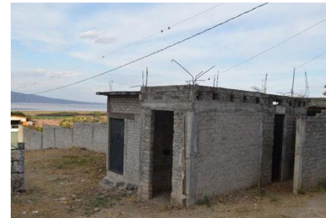
Foto 41. Vista del módulo sanitario existente, localizado en el área PROV-002, jaripeos. MCHB. 22/12/14.
