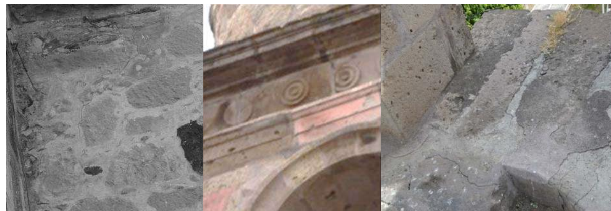
Foto 58. Grieta intervenida. MCHB. 23/12/14.
