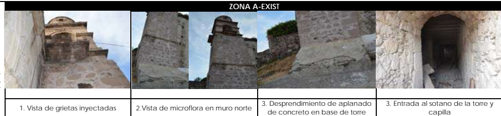
1. Vista de grietas inyectadas 2. Vista de microflora en muro norte 3. Desprendimiento de aplanado de concreto en base de torre 3. Entrada al sótano de la torre y capilla
