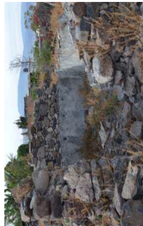
F40_CIMIENTOS DE ESPACIO PRESENTA APLANADO DE CEMENTO_231214_MCHB
