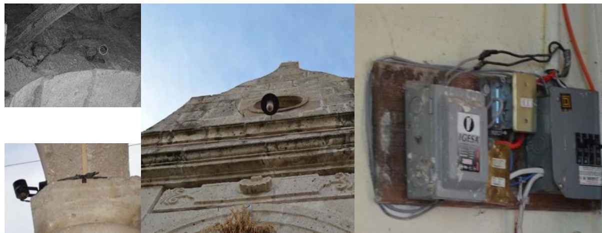
Foto 69. Instalación eléctrica en torre y arco del pórtico principal. Foto 68. Muros derrumbados. MCHB. 23/12/14.
