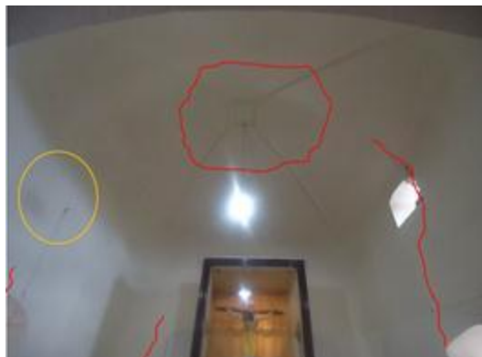
Fig. 7.13 Deterioros en el interior del presbiterio Foto: Hugo Angel Orozco Santibáñez
