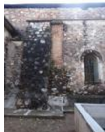
Foto ext. 11 Contrafuertes y vanos de ventanas, muro norte Fuente: Hugo Angel Orozco Santibáñez
