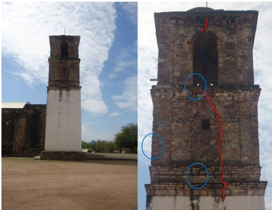
Fig. 7.3 Deterioros de la torre campanario Foto: Hugo Angel Orozco Santibáñez
