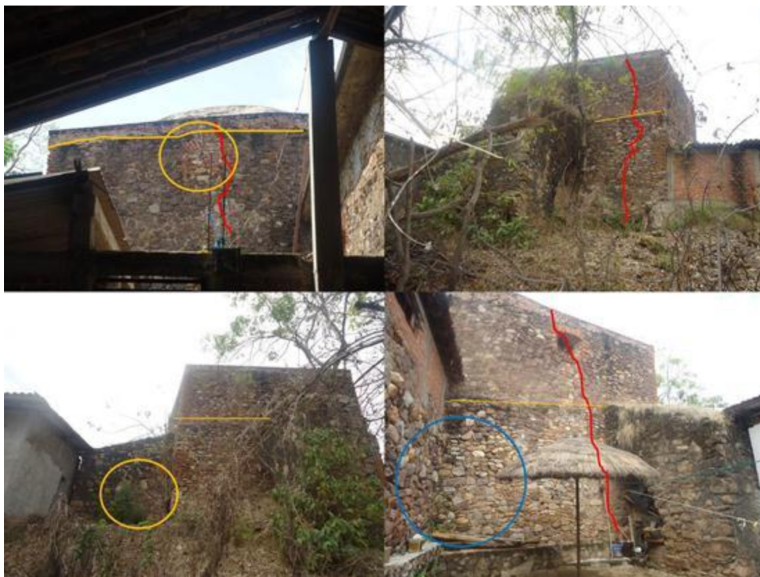
Fig. 7.12 Deterioros en el exterior del ábside Foto: Hugo Angel Orozco Santibáñez
