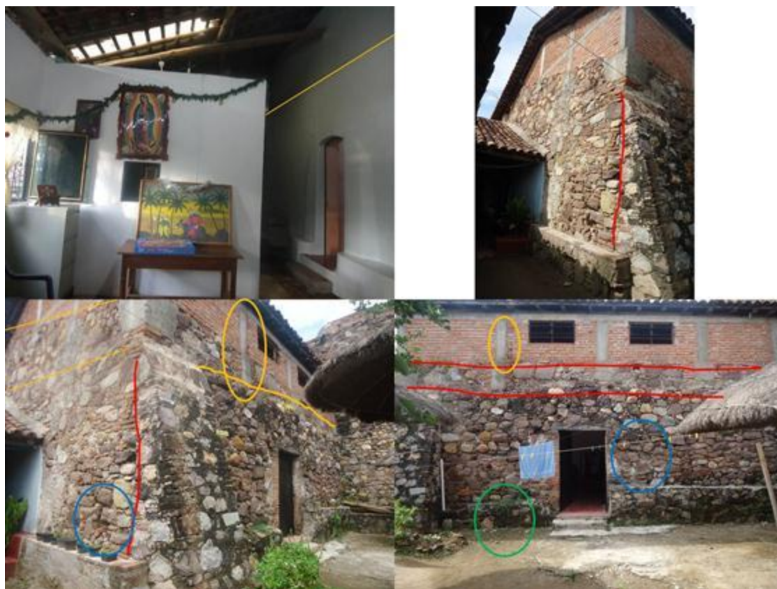
Fig. 7.8 Deterioros en el exterior de la capilla Foto: Hugo Angel Orozco Santibáñez
