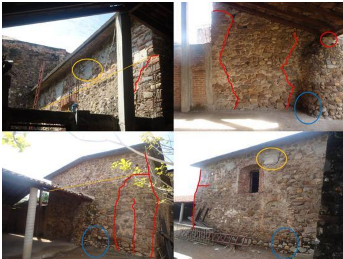
Fig. 7.6 Deterioros en el exterior de la capilla Foto: Hugo Angel Orozco Santibáñez
