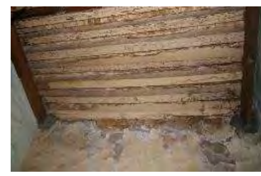
IMAGEN: 375 Muro de la cocina - comedor disgregación y pérdida de aplanados por presencia de humedad.
