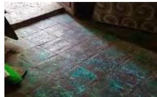
IMAGEN: 049 Piso de la sala (2) presenta perdida de junta y pintura
