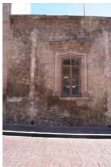
IMAGEN: 112 Vista de la fachada cambio de color por la presencia de humedad.
