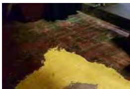
IMAGEN: 362 Piso del dormitorio – closet fractura perdida de juntas y piezas.
