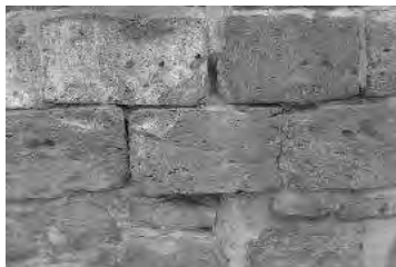
IMAGEN: 351 Disgregación y pérdida de material de juntas a causa del viento, el sol y la humedad.
