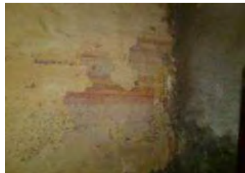
IMAGEN: 371 Muro del estudio disgregación y pérdida de aplanados por presencia de humedad.
