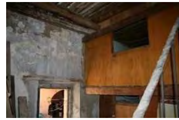
IMAGEN: 044 Desprendimiento y perdida de aplanados, mezanine empotrado, en los muros del contiguo a la cocina
