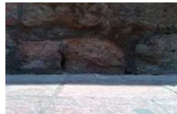
IMAGEN: 352 Disgregación de elementos de piedras de cantería por la presencia humedad.
