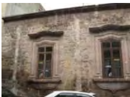
IMAGEN: 022 Vista cambio de color y humedad en la fachada del inmueble.
