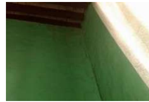
IMAGEN: 343 Grieta vertical en muro de sala lado derecho
