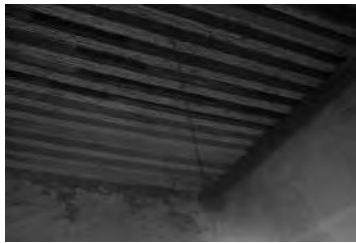
IMAGEN: 396 Vigería en el vestíbulo presenta desintegración de la madera por descomposición de la madera y colocación de añadidos de madera.
