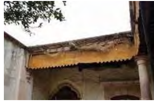
IMAGEN: 040 Perdida de juntas y crecimiento de plantas en la cornisa del patio principal
