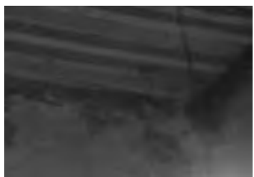
IMAGEN: 373 Muro de la sala (2), disgregación, pérdida de aplanados por presencia de humedad, colocación de añadido de madera.
