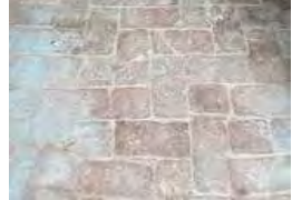
IMAGEN: 364 Piso del almacén perdida de juntas y pintura.
