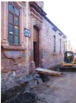
IMAGEN: 100 Vista de cepa abierta en la fachada de la vivienda
