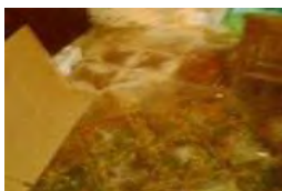
IMAGEN: 358 Piso del estudio con presencia de humedad y sales por humedad.
