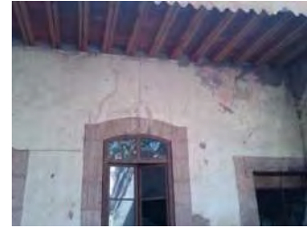
IMAGEN: 378 Grieta diagonal del muro este del patio principal.
