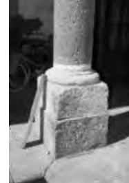
IMAGEN: 491 Disgregación y oquedades en la base y el cuerpo de la columna.
