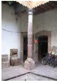
IMAGEN: 386 Cambio de color por acción del intemperismo de sol y la temperatura.
