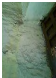
IMAGEN: 341 Grieta vertical en muro del zaguán lado derecho
