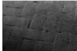
IMAGEN: 360 Piso de la recamara perdida de juntas y pintura.
