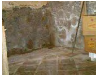
IMAGEN: 345 Humedad en el muro y el piso del estudio, provocando la presencia de sales y sulfatos.
