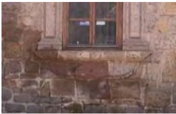
IMAGEN: 347 Presencia de humedad parte inferior del muro de la fachada.
