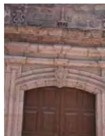
IMAGEN: 356 Fractura y pérdida de material del elemento de cantería de la tapa del acceso de la fachada.
