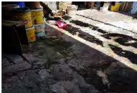
IMAGEN: 368 Piso de loseta de cantería del patio secundario presenta fractura y pérdida de piezas desnivel pérdida de juntas, crecimiento de microflora.
