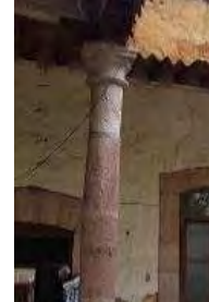
IMAGEN: 388 Desplome y sustitución de juntas cal arena - por juntas de mortero a base de cemento
