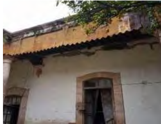
IMAGEN: 377 Grieta horizontal muro del sur del patio principal.
