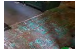
IMAGEN: 361 Piso del vestibulo perdida de juntas y pintura.
