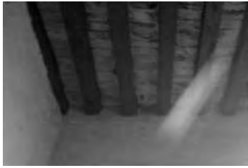
IMAGEN: 045 Viguera de sala (1) de la vivienda, muestra indicios de ser sustituida.
