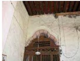
IMAGEN: 404 Cables y de la instalación eléctrica conducidos en el muro del corredor
