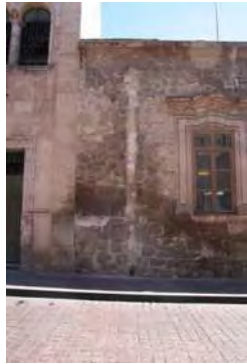
IMAGEN: 353 Deterioro causado por el ranura do y colocación de bajada de agua empotrada en el muro lado izquierdo.
