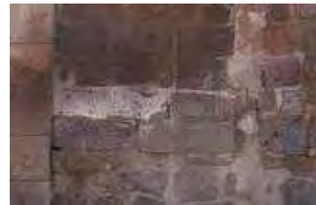
IMAGEN: 349 Perdida de material por disgregación de las piedras de cantería.
