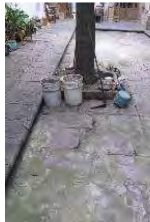
IMAGEN: 367 Piso de loseta de cantería del patio principal, pérdida de juntas desnivel y crecimiento de microflora.
