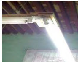
IMAGEN: 405 Lámparas fluorescentes colocadas en el estudio de la vivienda.
