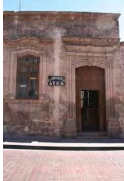
IMAGEN: 354 Deterioro causado por el ranurado y colocación de bajada de agua empotrada en el muro lado derecho.
