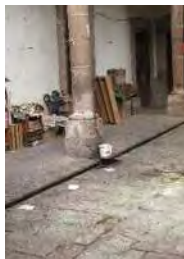
IMAGEN: 389 Alteración por la colocación de instalación hidráulica para una toma de agua potable
