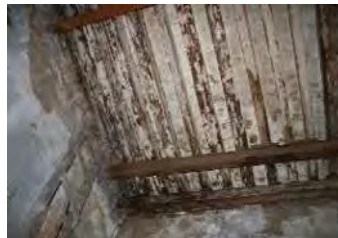
IMAGEN: 046 Viguera del espacio continuo a la cocina (1) presencia de descomposición y colocación de añadidos de madera
