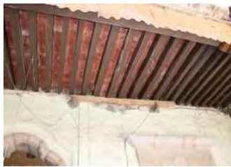
IMAGEN: 376 Grieta del muro oeste horizontal del muro este del patio principal.
