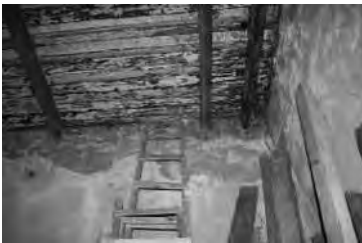
IMAGEN: 395 Vigería de la recámara (2) presenta desintegración de la madera por descomposición de la madera y colocación de añadidos de madera.
