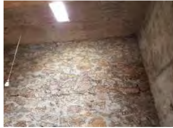
IMAGEN: 058 Muro reconstruido con mortero a base de cemento y falta de aplanados
