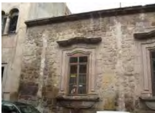
IMAGEN: 344 Humedad en la parte inferior de la fachada principal,
