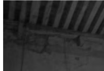
IMAGEN: 372 Muro del almacén, disgregación, pérdida de aplanados por presencia de humedad, colocación de añadido de madera.
