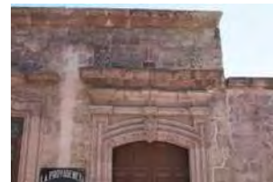
IMAGEN: 114 Pérdida de las gárgolas para el desalojo de agua pluvial y colocación de bajadas empotradas en el muro
