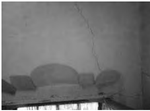
IMAGEN: 381 Grieta en vertical en la por asentamiento del muro de la recámara (1).
