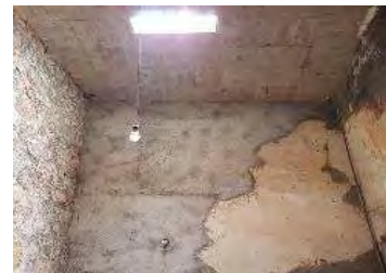
IMAGEN: 059 Losa de concreto armado en espacio de la cocina en el segundo patio
