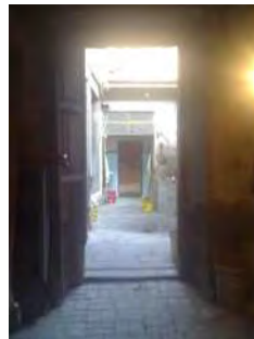
IMAGEN: 064 Puerta deteriorada que da acceso al patio secundario
