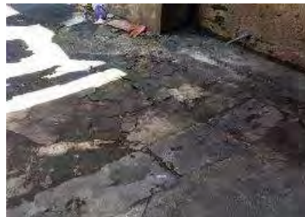
IMAGEN: 369 Piso de loseta de cantería del patio secundario presenta colocación de firme de concreto
