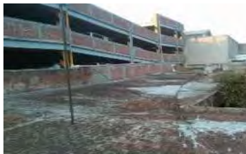
IMAGEN: 401 Desnivel y pérdida de pendientes de la cubierta y agregados para satisfacción de servicios.
