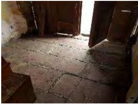
IMAGEN: 366 Piso de loseta de cantería del zaguán pérdida de junta y desgaste por uso.
