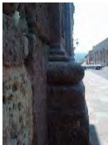
IMAGEN: 350 Alveolos de elementos de cantería por la presencia de sales y sulfatos.
