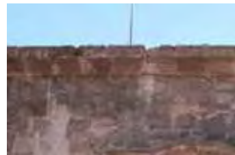
IMAGEN: 357 Fractura y pérdida de material de los elementos de cantería de la cornisa de la fachada.
