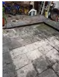
IMAGEN: 037 Losetas de cantería con crecimiento de microflora del patio principal
