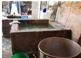
IMAGEN: 052 Pileta y lavadero ubicados en el patio secundario
