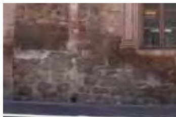
IMAGEN: 348 Disgregación de las piedras de cantería por humedad y factores ambientales.
