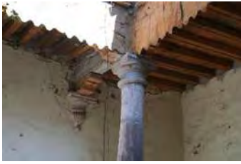
IMAGEN: 033 Columna del corredor con desplome y cambio de color.
