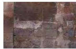
IMAGEN: 024 Deterioro de los elementos de cantería en la fachada del inmueble.
