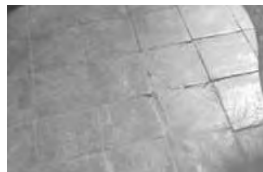
IMAGEN: 359 Piso de sala perdida de juntas y pintura.
