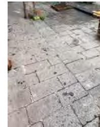
IMAGEN: 038 Perdida de juntas y nivel osetas de cantería del patio principal
