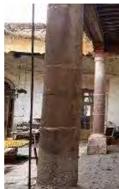
IMAGEN: 390 Alteración por la colocación tubería para la instalación hidráulica.
