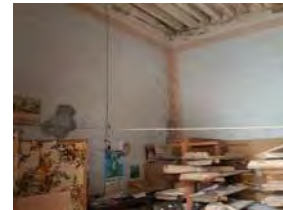
IMAGEN: 406 Bajada del apagador ubicado en local del almacén.
