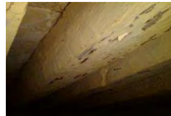
IMAGEN: 047 Viguera de la recamara (1) presenta grietas y perdida de pintura.
