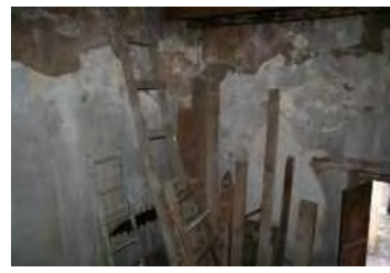
IMAGEN: 374 Muro de la recámara (2) disgregación y pérdida de aplanados por presencia de humedad.
