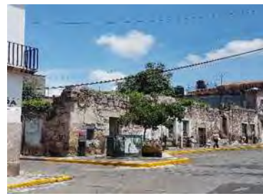
IMAGEN: 011 Casa en ruinas en la esquina Vicente Santa María y Mariano Elizaga.
