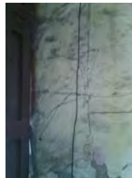
IMAGEN: 242 Grieta vertical en muro del zaguán lado izquierdo
