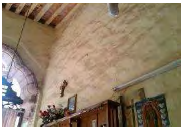
IMAGEN: 370 Muro del Zaguán descohesión del aplanado muro y deformación por humedad del muro.
