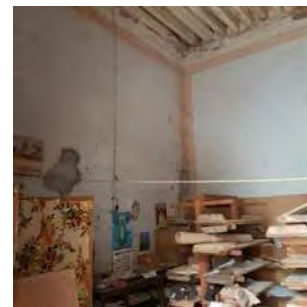
IMAGEN: 098 Aplanados de mortero de cal recubiertos con pintura vinilica en área usada como almacén.
