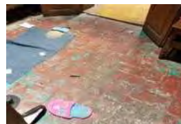
IMAGEN: 363 Piso del vestibulo perdida de juntas y pintura.
