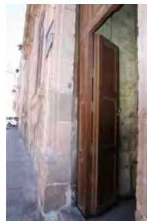
IMAGEN: 113 Pérdida de plomo del muro de mampostería de la fachada principal
