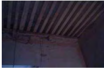
IMAGEN: 393 Vigería del almacén presenta desintegración de la madera por descomposición de la madera y colocación de añadidos de madera.
