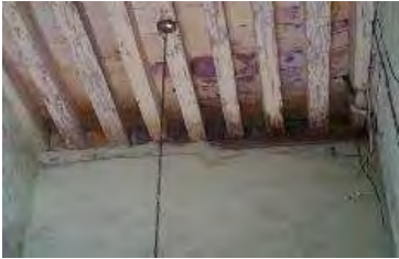
IMAGEN: 392 Vigería del zaguán presenta desintegración de la madera por descomposición en los extremos y colocación de añadidos de madera.
