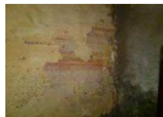
IMAGEN: 346 Humedad en el muro, pérdida y disgregación de aplanados los muros del estudio
