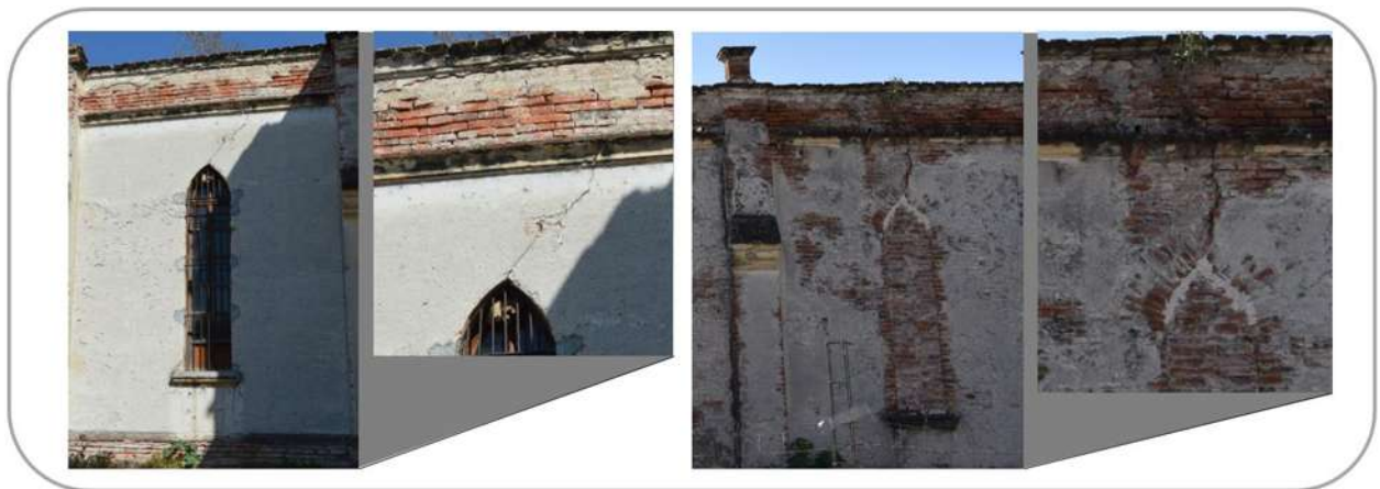
Fig.115: Grietas presentes en los muros de la sacristía, debido a crecimiento de macroflora y producto de malas intervenciones, respectivamente. Fuente: Imágenes tomadas por el autor.
