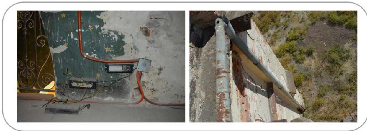
Fig.122: Deterioros en Instalaciones eléctricas y en instalaciones de desagüe pluvial, respectivamente. Fuente: Imágenes tomadas por el autor.
