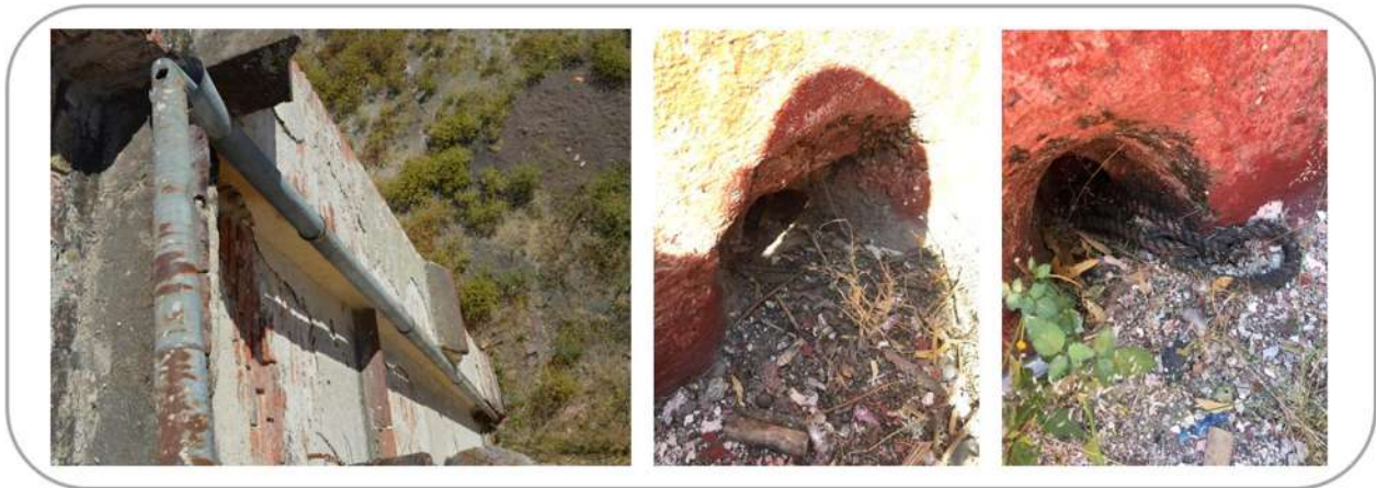
Fig.95 y Fig.96: Instalaciones de evacuación de aguas pluviales actuales y salidas obstruidas con basura acumulada, respectivamente. Fuente: Elaborado por Eliber Rieche Vilches.
