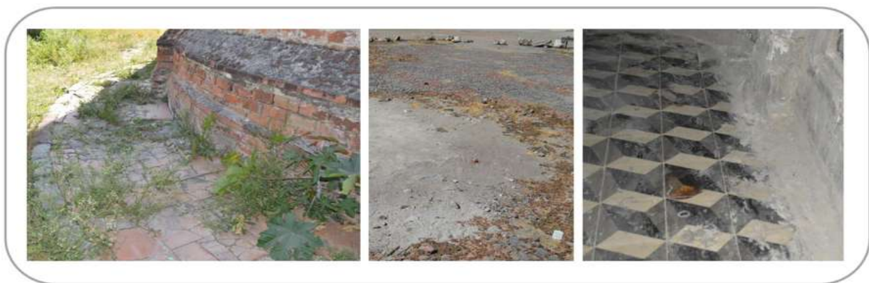
Fig.112: Pisos exteriores e interiores más deteriorados, banqueta de baldosas de barro, piso de lajas de piedra del atrio y piso de baldosa de pasta de cemento del mausoleo. Fuente: Imágenes tomadas por el autor.
