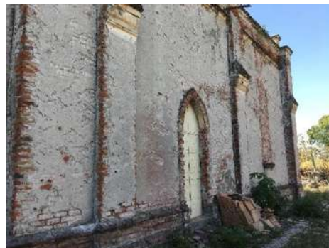
Fig.83 y Fig.84: Arco de descarga típico sobre vanos ojivales y fachada posterior, arcos de descargas y vanos tapiados. Fuente: Fotografía tomada por el Autor.
