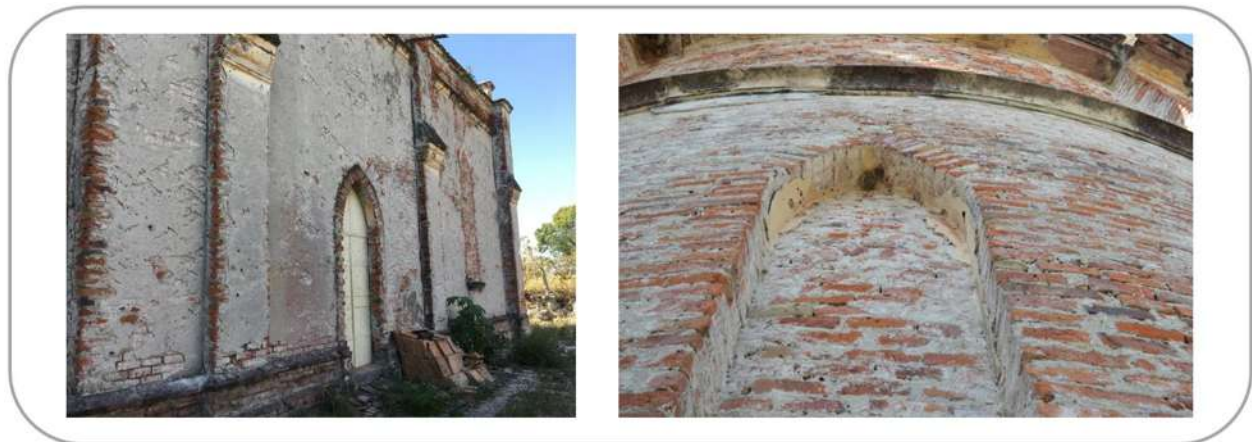
Fig.118: Deterioros en cerramientos, por infiltración de humedad por capilaridad y deterioro de juntas y aplanados de elementos orientados hacia el este, respectivamente. Fuente: Imágenes tomadas por el autor.
