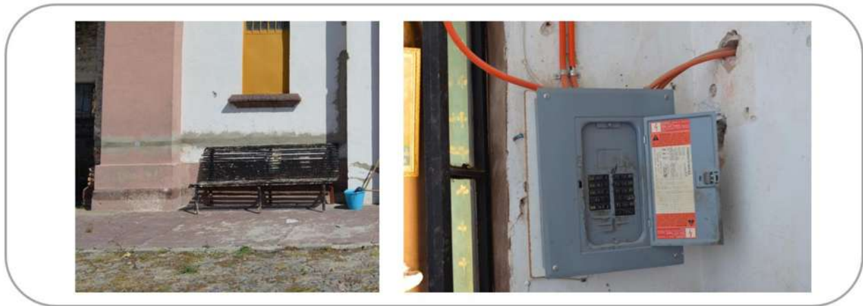
Fig.92 y Fig.93: Conexión de abastecimiento eléctrica en fachada y PGD, Pizarra General de Distribución, respectivamente. Fuente: Elaborado por Eliber Rieche Vilches.
