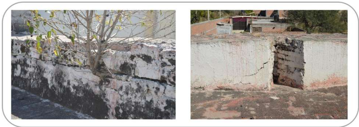
Fig.114: Causantes de las grietas presentes en los muros de la sacristía, presencia de macroflora y malas intervenciones en las instalaciones de desagüe pluvial, respectivamente. Fuente: Imágenes tomadas por el autor.
