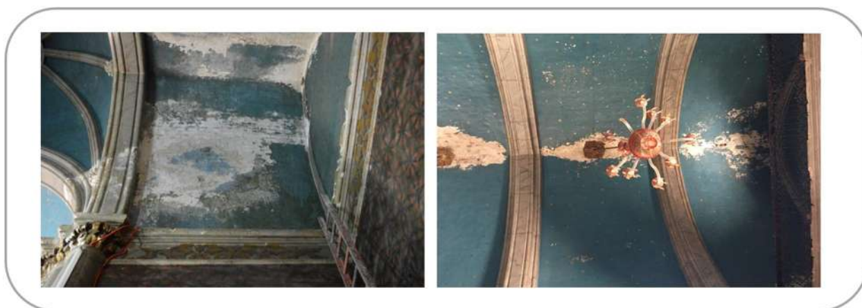
Fig.119: Deterioros en cubiertas, infiltración de humedad desde el área de rellenos de la bóveda de cañón corrida e infiltración por el mal anclaje de los candelabros, respectivamente. Fuente: Imágenes tomadas por el autor.
