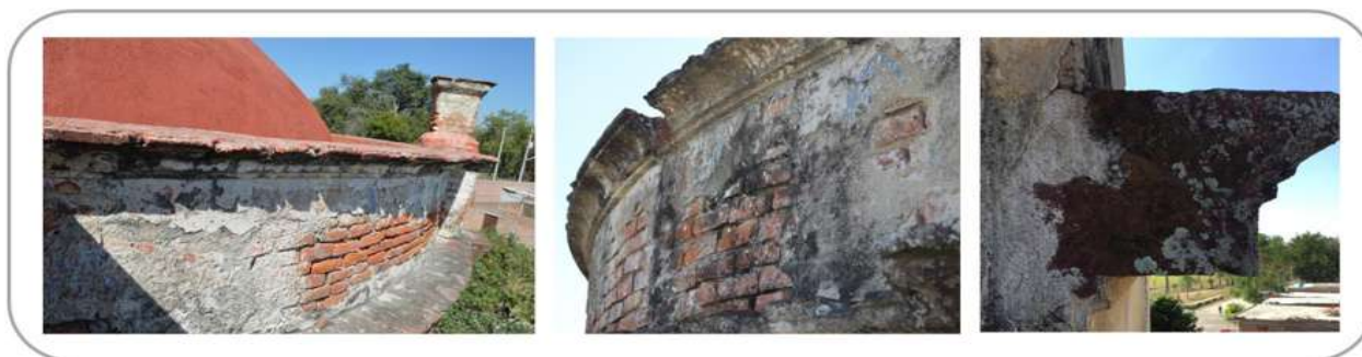
Fig.120: Deterioros en Cornisas y molduras exteriores, respectivamente. Fuente: Imágenes tomadas por el autor.
