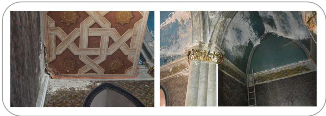
Fig.121: Deterioros en Plafón de lienzo y molduras decorativas de yeso, respectivamente. Fuente: Imágenes tomadas por el autor.
