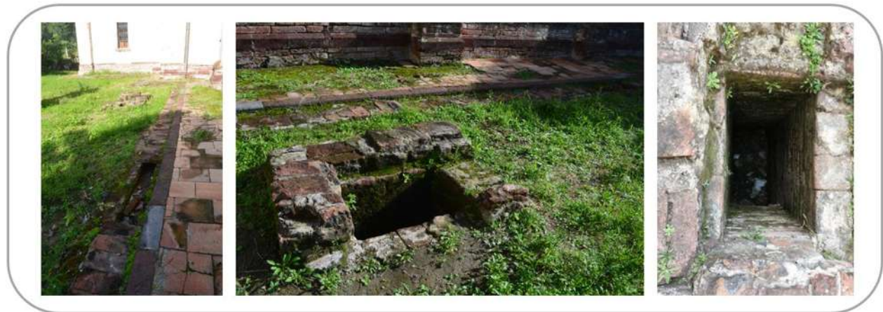
Fig.99 y Fig.100: Canales colectores de aguas pluviales en el patio y registros generales ubicados a ambos lados de la capilla, respectivamente. Fuente: Elaborado por Eliber Rieche Vilches.
