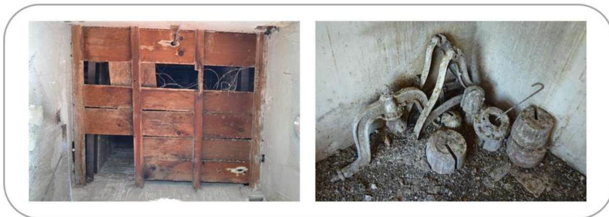
Fig.116: Deterioros en entrepisos, Vigería y entablado en mal estado y acumulación de escombros y excremento animal, respectivamente. Fuente: Imágenes tomadas por el autor.
