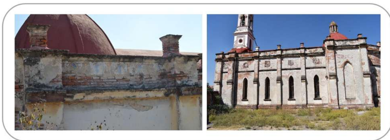
Fig.113: Deterioros en muros, despigmentación en la pintura mural de exteriores y pérdida de aplanados en fachadas con orientación este. Fuente: Imágenes tomadas por el autor.
