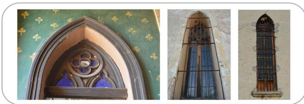
Fig.119: Deterioros en Carpinterías, en interiores y exteriores, respectivamente. Fuente: Imágenes tomadas por el autor.
