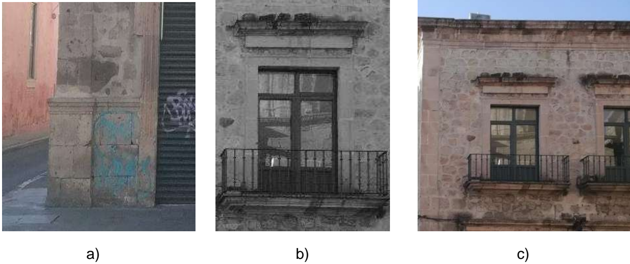
Figura 50. a) Zócalo de piedra de cantería aparente y base de pilastra. Foto: CEC. b) Detalle balcón segundo nivel. Foto: CEC. c) Fachada norte segundo nivel. Foto: CEC
