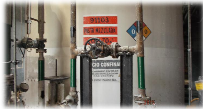
Figura 4.- Tanque de pasta mezclada.
