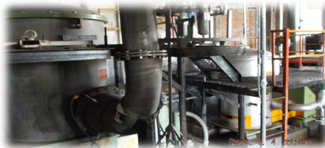
Figura 6.- Sistema de depuradores.
