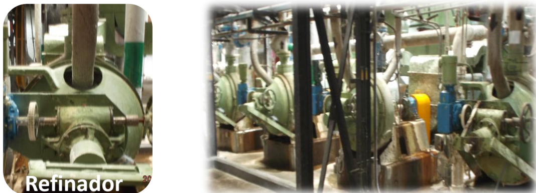
Figura 3.- Tren de refinadores para celulosa.
