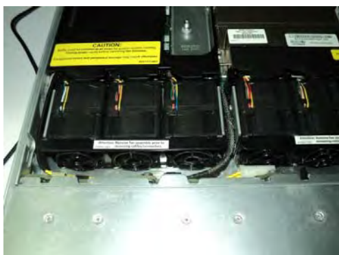
c) Sistema de refrigeración del equipo de cómputo
