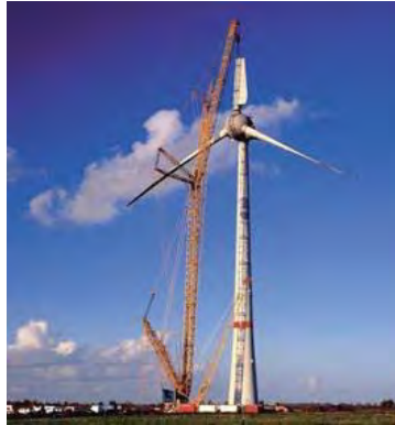
Figura 1.4 Aerogenerador de 6 Mw y 126 metros de diámetro en la turbina eólica.
