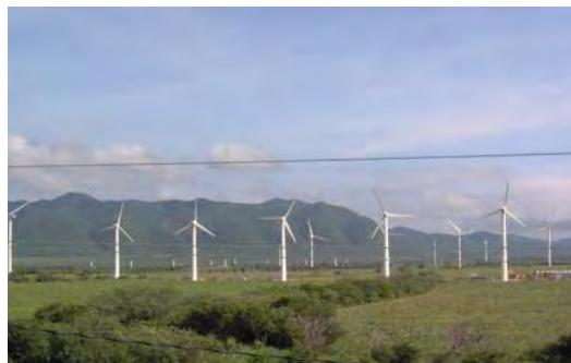
Figura 1.11 Parque eólico La Venta II [CFE07].
