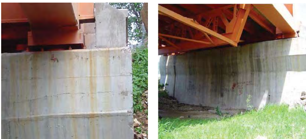
Figura 2-5. Aisladores en los estribos (vista de estribo 6)
