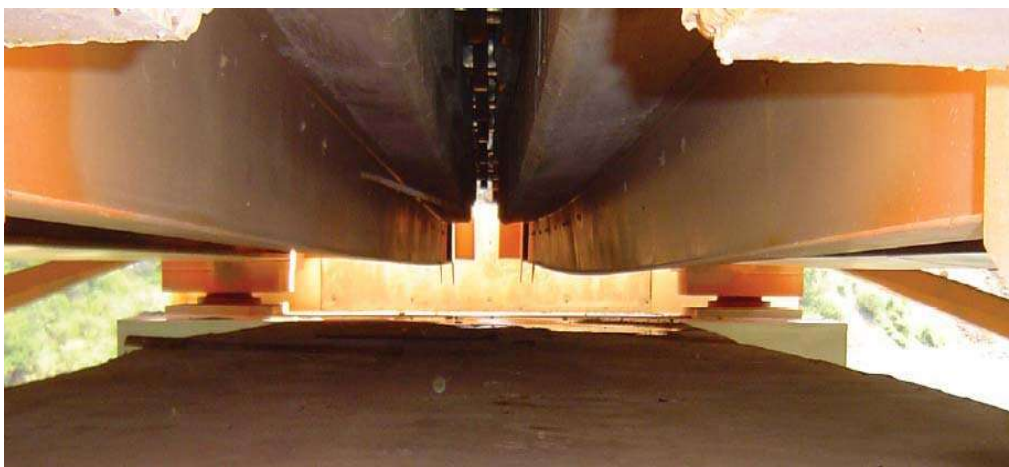
Figura 2-6. Aisladores en las pilas (vista de medio cabezal, pila 4).
