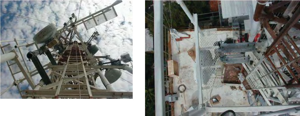
Figura 2.3.2 Sistema de ascenso-descenso en la torre
