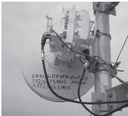
(c) Vista posterior y cables
