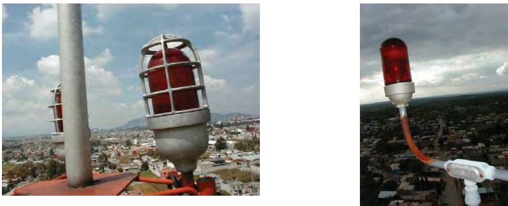
Figura 2.3.6 Sistema de iluminación o Balizamiento nocturno
