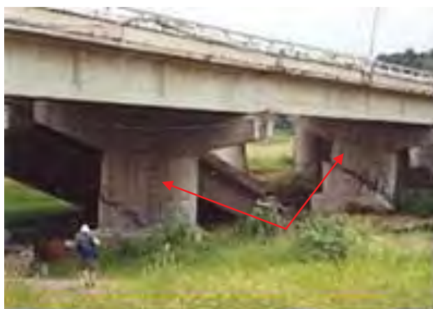
Figura 3.- Desplome de dos tramos de superestructura y falla por cortante (líneas en color rojo) en las pilas debido a una falla sísmica que cruza el puente ( http://nisee.berkeley.edu/taiwan/mahin/day02/day02.html )
