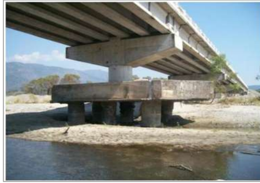
Figura 1. Socavación local en una de las pilas del Puente Pijijiapan I [Tomada de Aguado, 2012]
