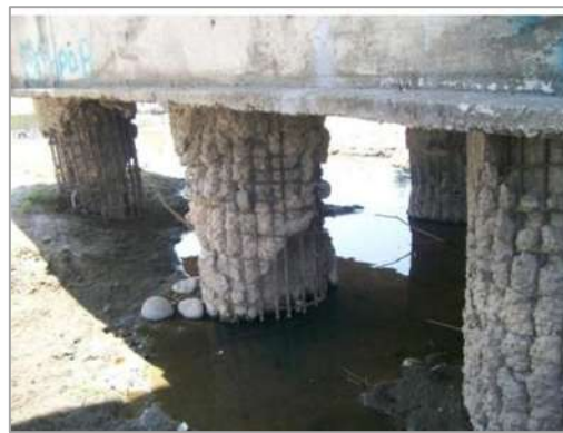
Figura 2. Problemas de degradación producto de socavación local de Puente Pijijiapan I [Tomada de Aguado 2012]
