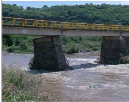
Figura 5. Pila dañada del puente Nexpa [Tomada de Aguado, 2012]
