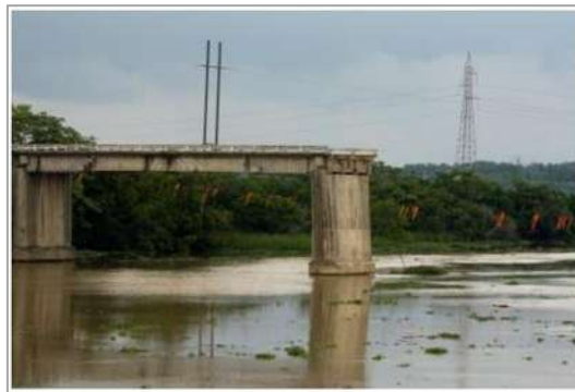
Figura 4. Restos del puente Tonalá [Tomada de Aguado, 2012]
