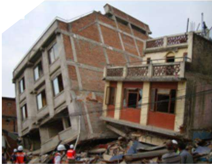
Figura 4.6 Falla estructural debida a planta baja débil y efectos de golpeteo sísmico
