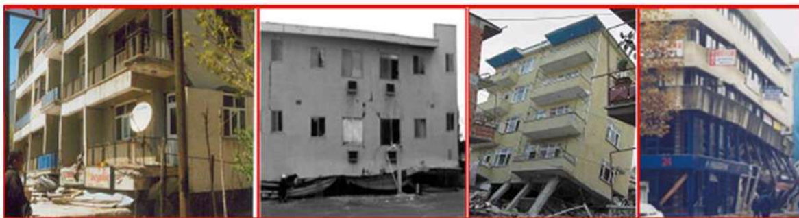
Figura 4.5 Daños por sismo causados por irregularidad de planta baja débil (Kirac et al.,2011).
