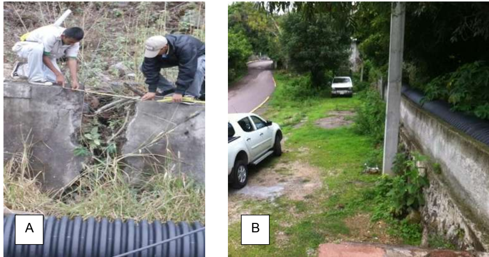
Figura 18. A) Ruptura del canal provocado por el desplazamiento del terreno; B) Colocación de tubería dentro del canal.
