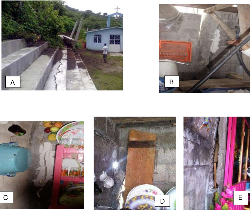
Figura 19. A) Frente de deslizamiento en el flanco noreste de la iglesia de la localidad. Sobre las gradas se observan depósitos de flujos de lodos. B) Fractura en el contacto de muro-castillo y flexión de castillo. Todo ello producto de la deformación del terreno sobre el que fue desplantada la construcción. C) Fractura en muro de tabicón. Nótese el rompimiento del resane anterior que revelan la deformación activa, así como magnitud de la apertura en la grieta que permite el paso de la luz exterior (2012). D) Fractura en muro de tabicón, de junio del 2015. E) Flexión y fractura en castillo.
