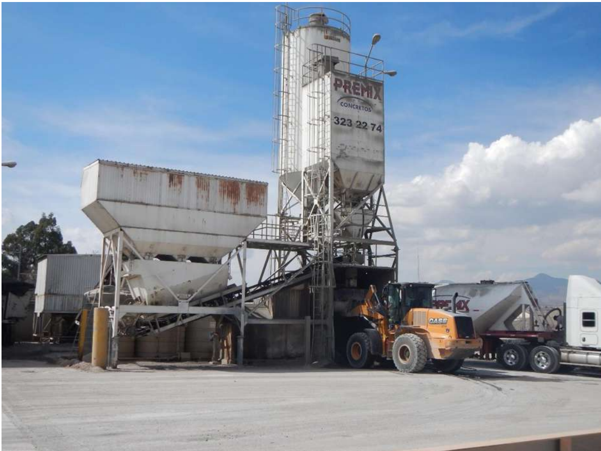
Figura 15.- Planta de mezclado de concreto.
