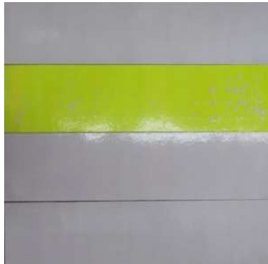
Figura 49. Defectos de los muros tipo sándwich.
