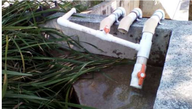
Figura 15 Válvulas de control
