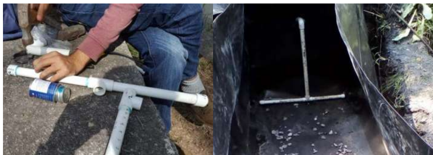
Figura 18. Tubería de recolección y salida
